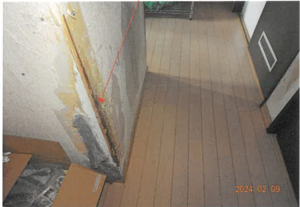
⑤ (1階リビングダイニング 内壁損傷箇所)
