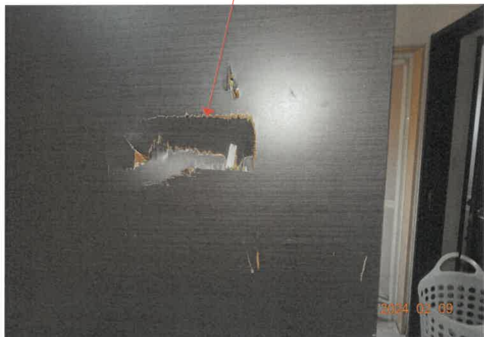
⑥ (1階洗面所 戸の破損箇所)
