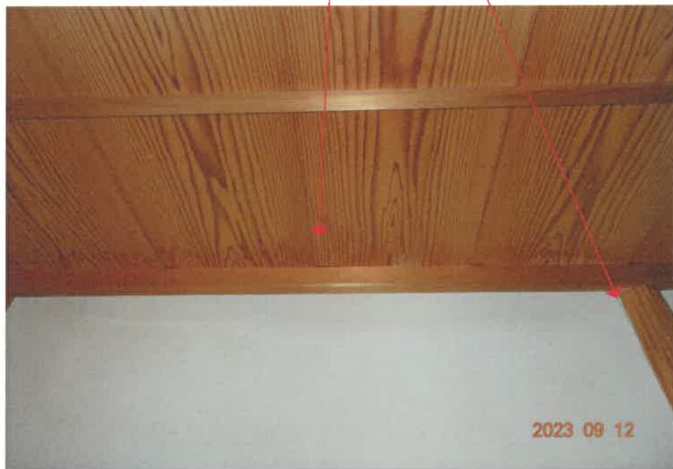
⑪ (1階南側和室 雨漏り跡・クラック)
