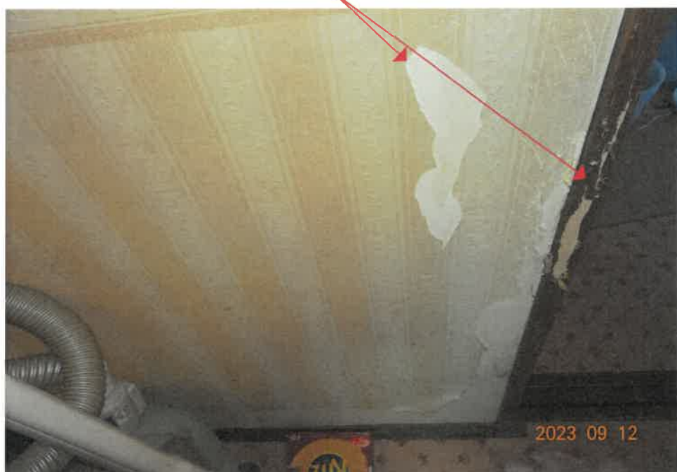
⑫ (1階リビングダイニング 内壁損傷箇所)
