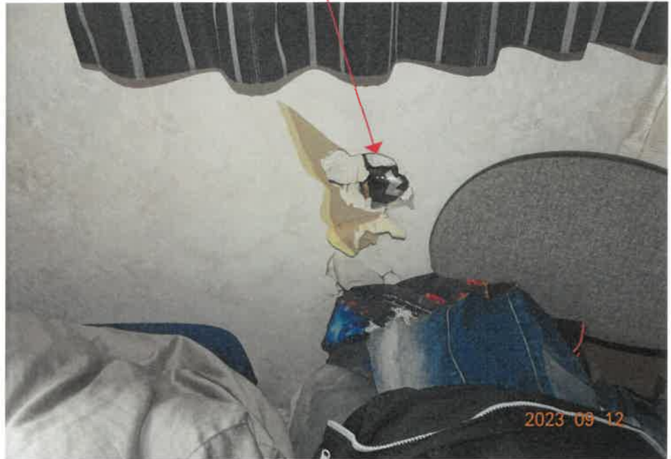
⑬ (2階東側洋室 内壁破損箇所)
