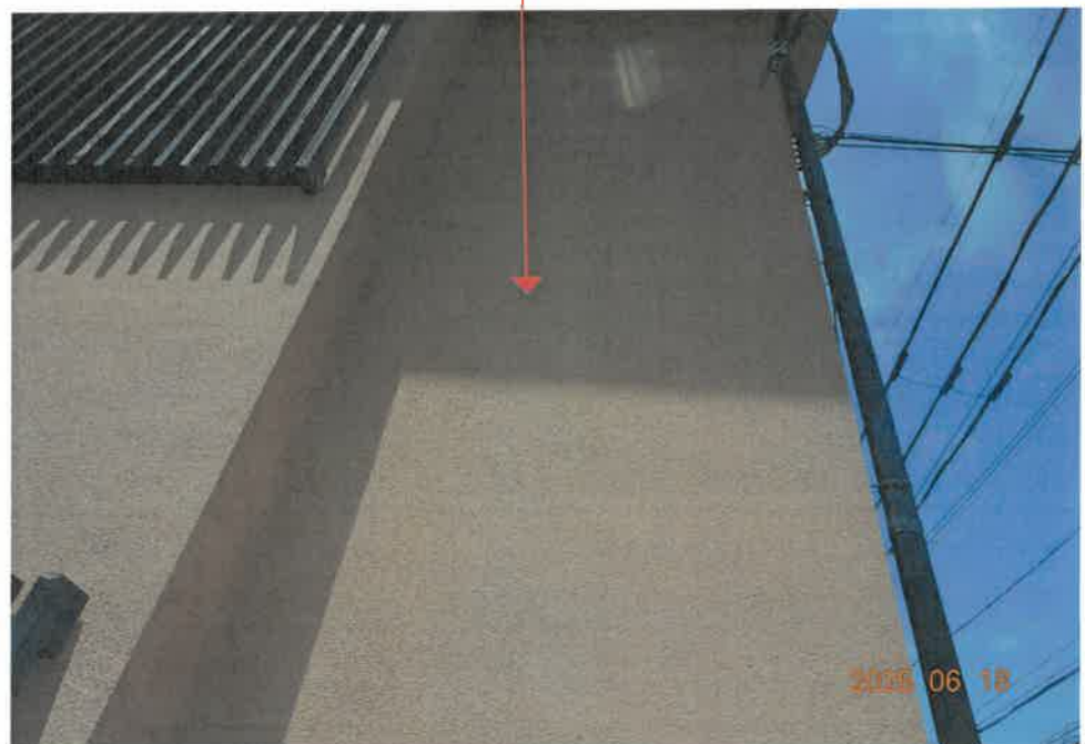
⑯ (外壁クラック)
