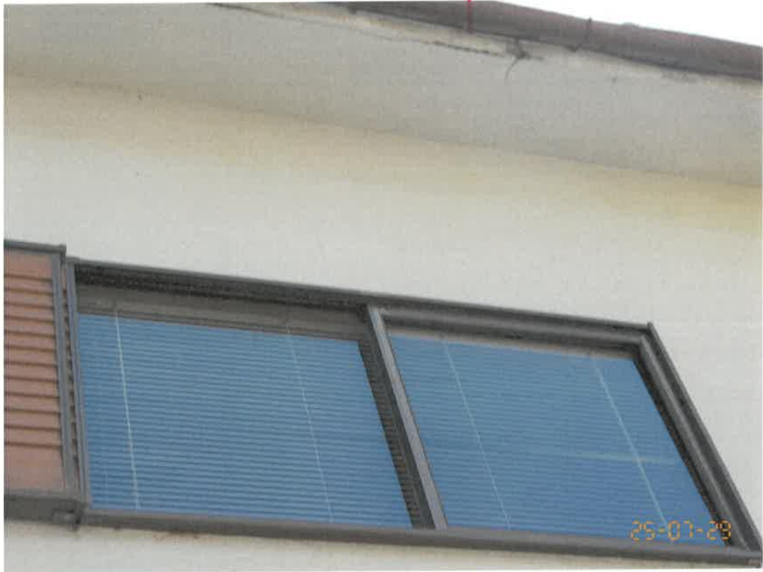
軒先の外壁損傷
