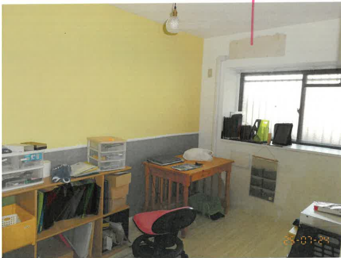
エアコンを取り外した跡
