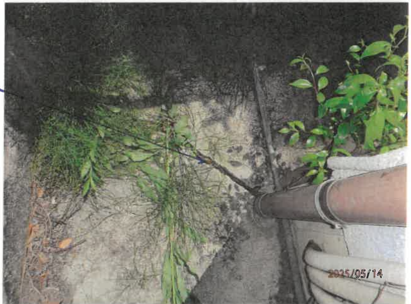
敷コンクリートの亀裂
