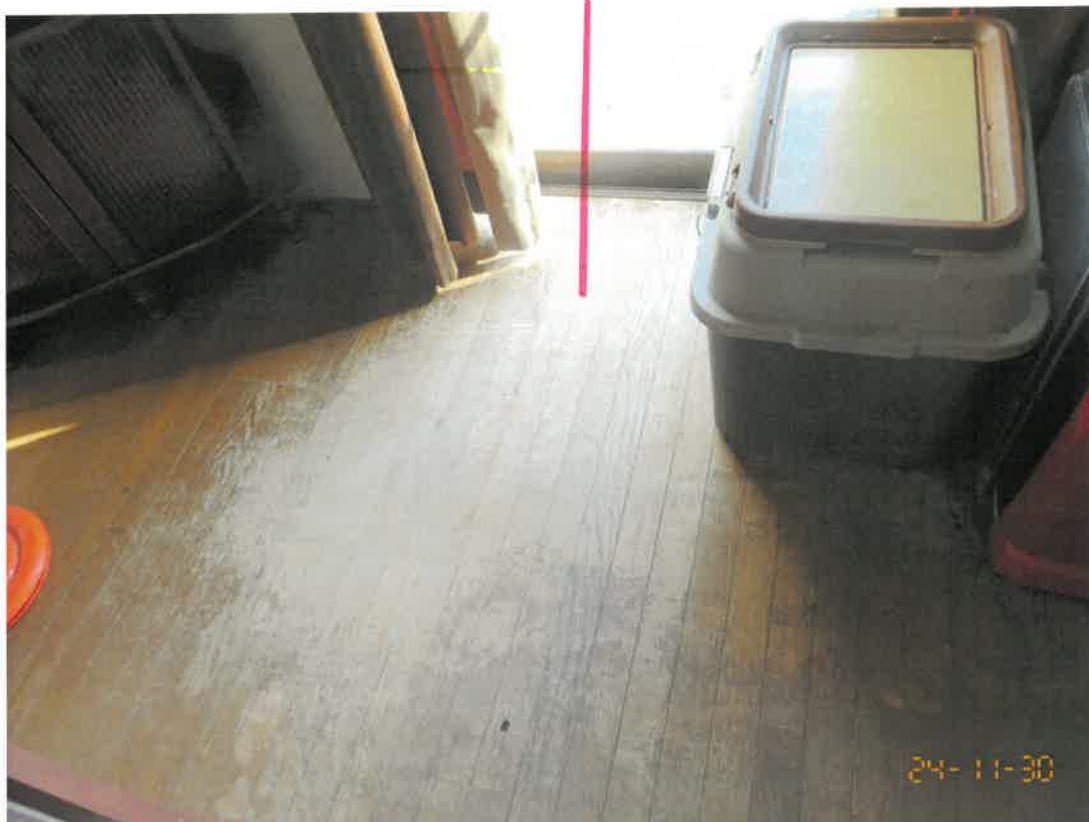
フローリングの劣化
