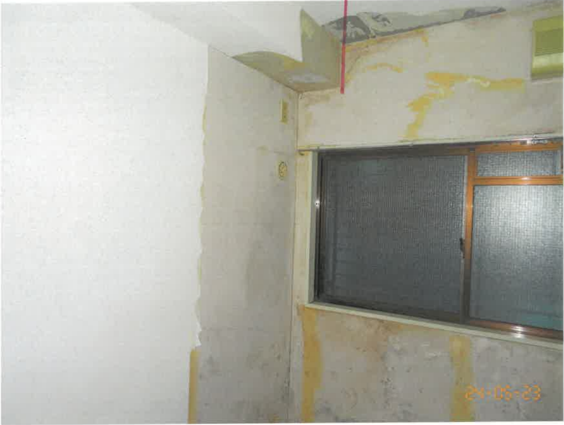
クロス剥がれ・汚れ
