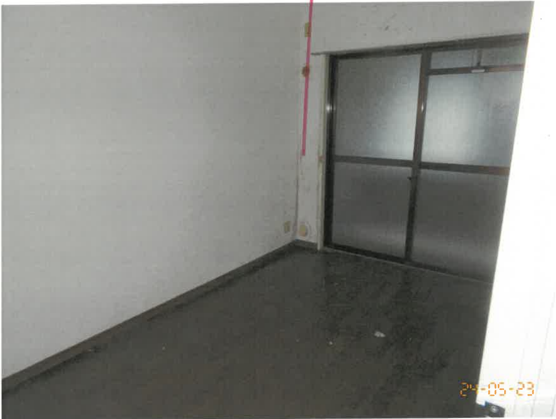
クロス剥がれ・汚れ
