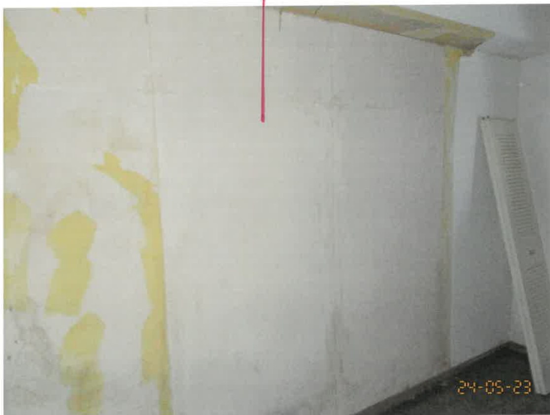
クロス剥がれ・汚れ
