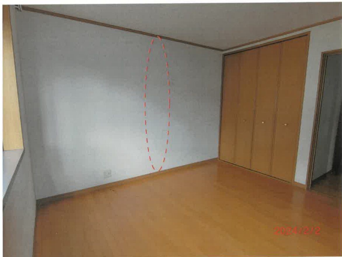
壁面クロスの亀裂状損傷状況
