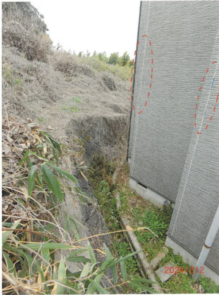
外壁サイディング つなぎ目コーキングの剥離状況
