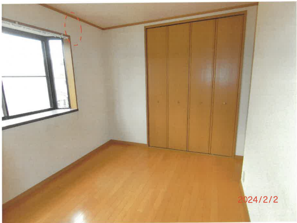
壁面クロスの亀裂状損傷状況
