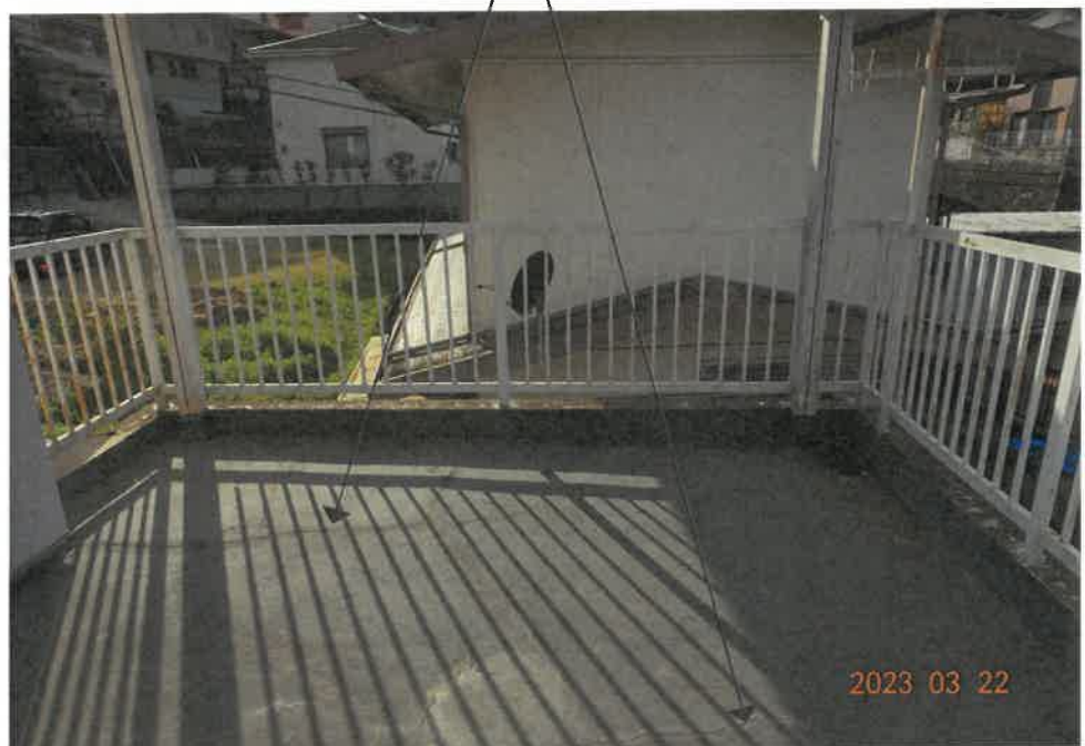
⑫ (2階ルーフバルコニー 亀裂)
