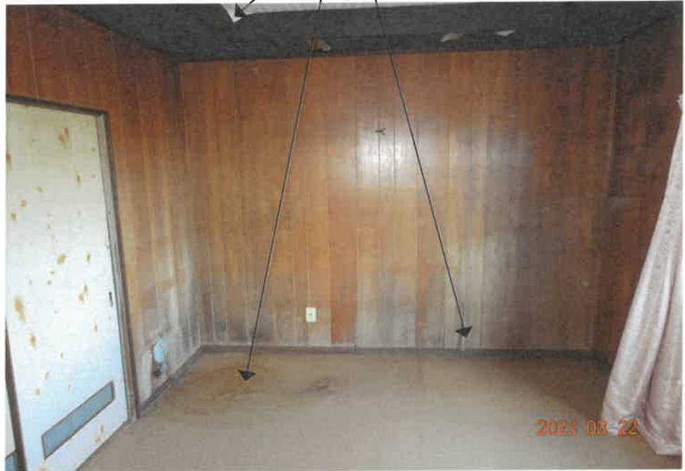
⑨ (1階北西側洋室 剥離・損傷箇所)
