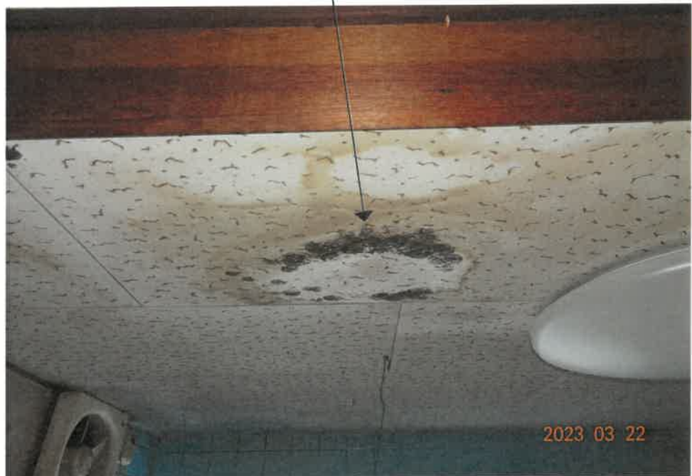
⑩ (1階DK 天井雨漏り跡)
