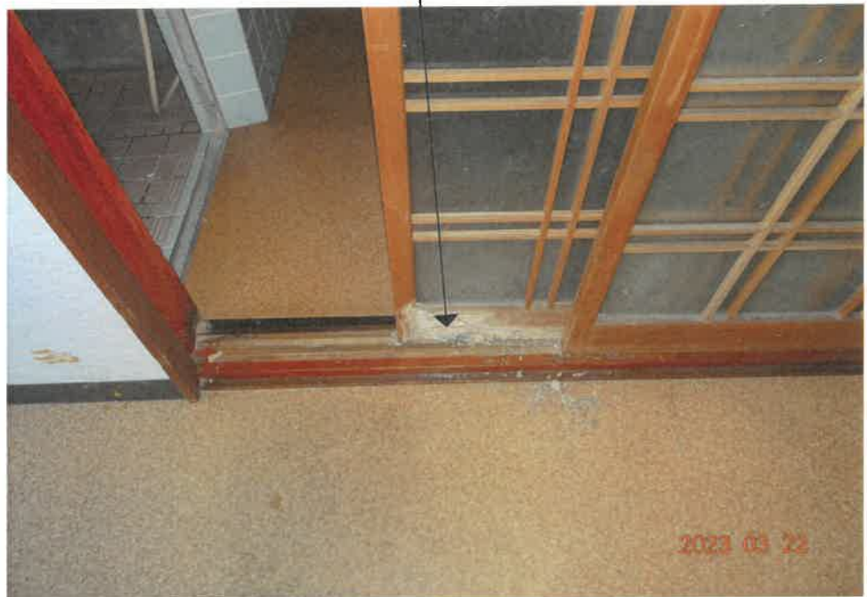
⑧ (1階洗面所引き戸 損傷箇所)
