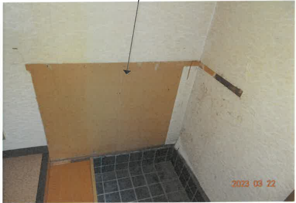
⑦ (1階玄関 クロス剥離箇所)
