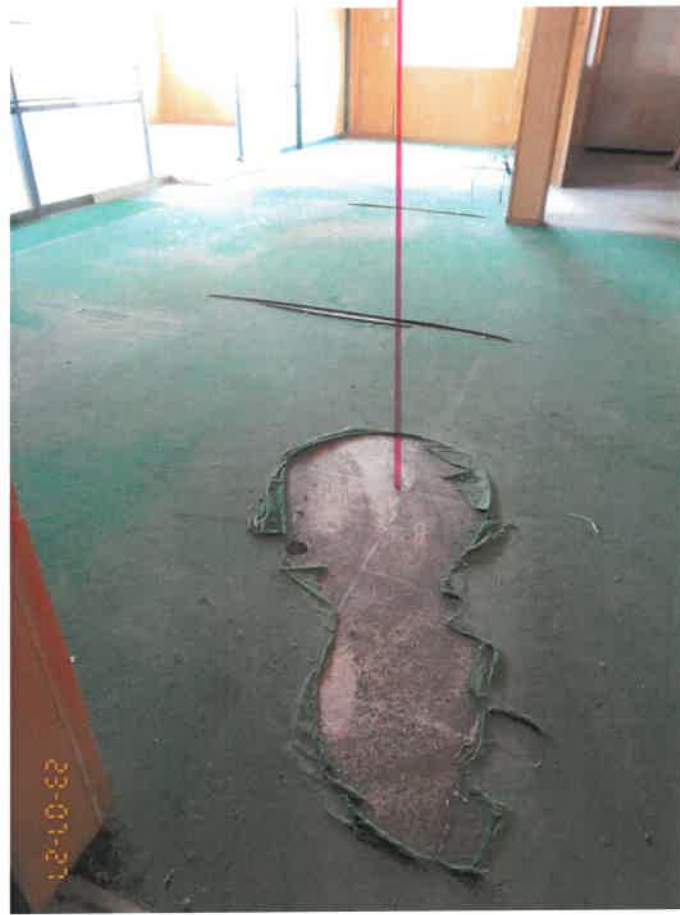
カーペットの剥がれ
