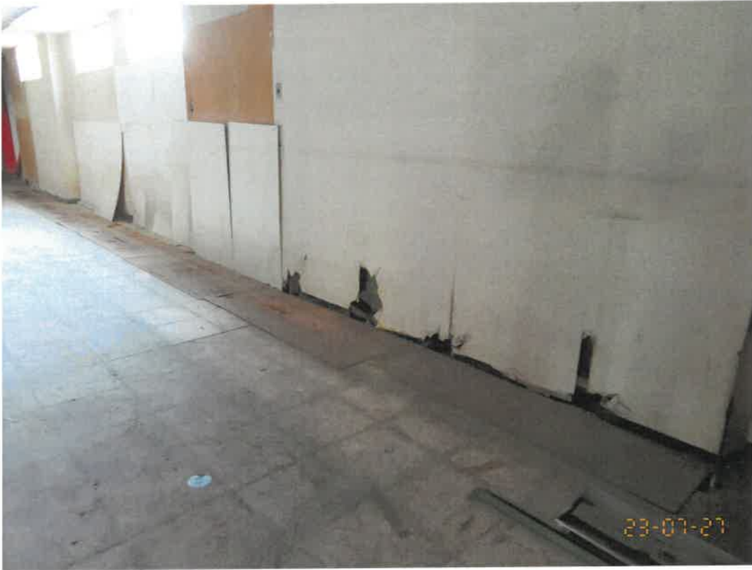
ボードの損傷
