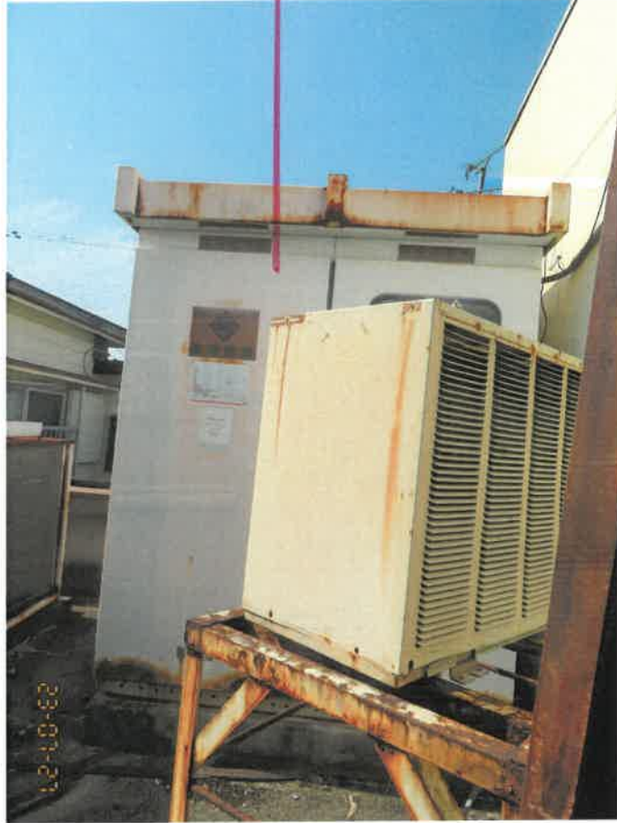
キュービクル(高圧変電設備)
