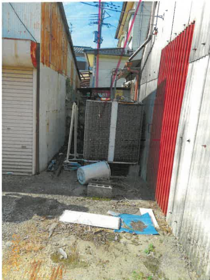
プロパン庫 室外機
