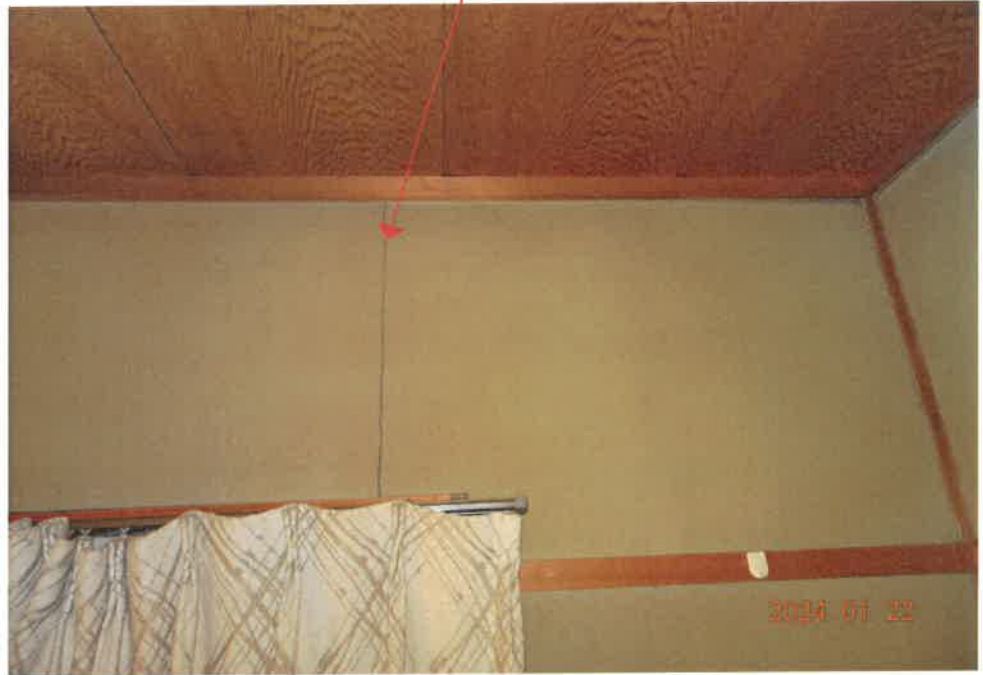
⑮ (2階和室8帖 内壁クラック)
