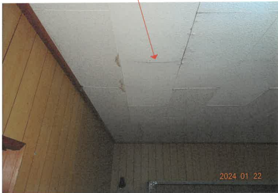
⑤ (1階倉庫包装室 天井たわみ)
