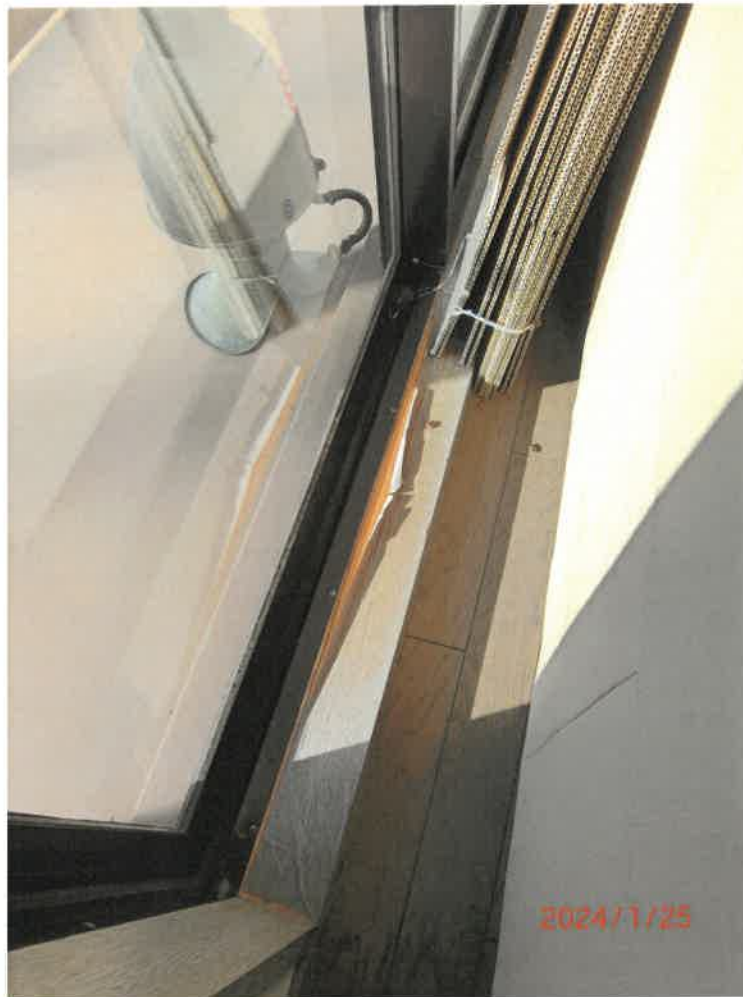
サッシ戸木枠部分の劣化状況
