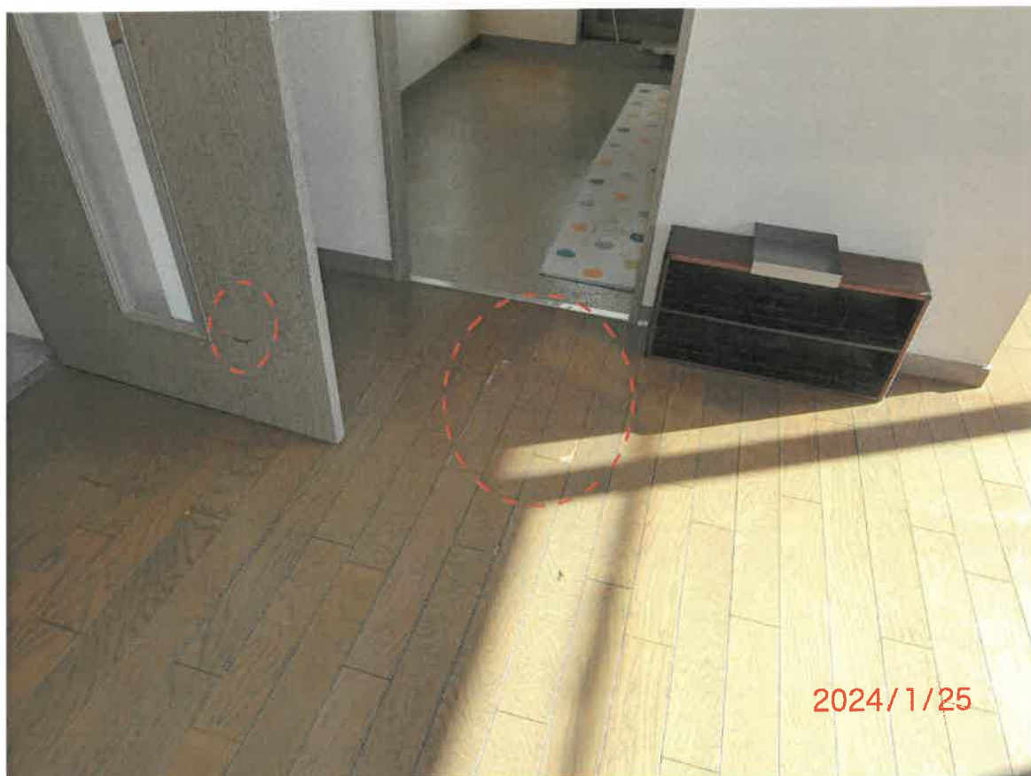
度合いタブの陥没状損傷及びLD床面の表面材の剥離損傷状況
