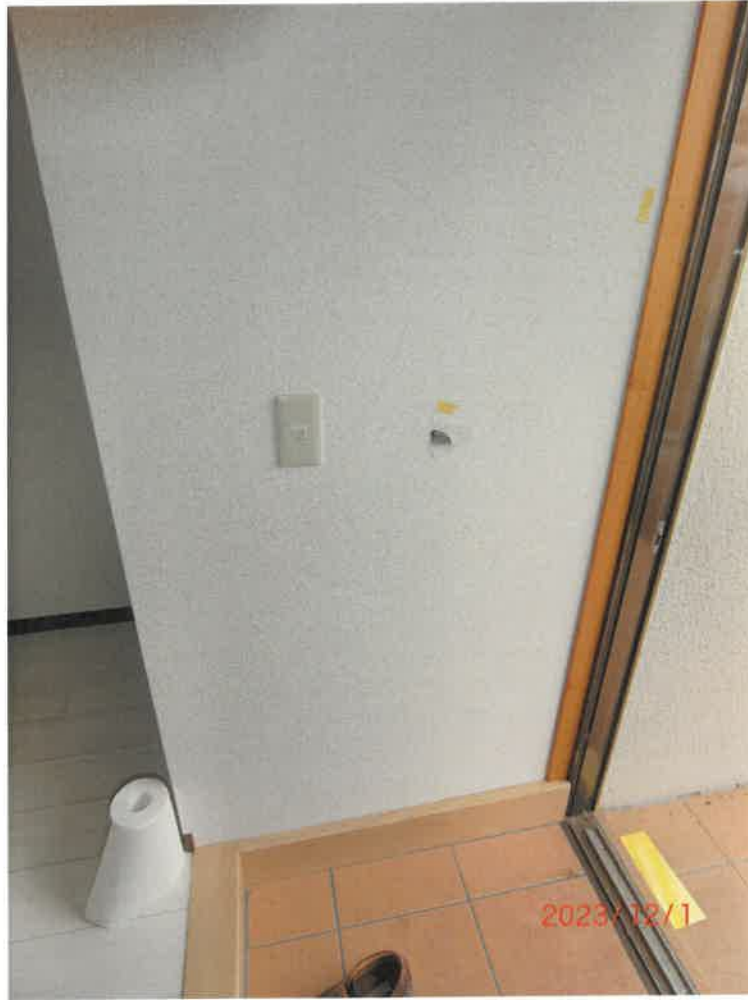
1階玄関壁面の陥没状損傷の状況
