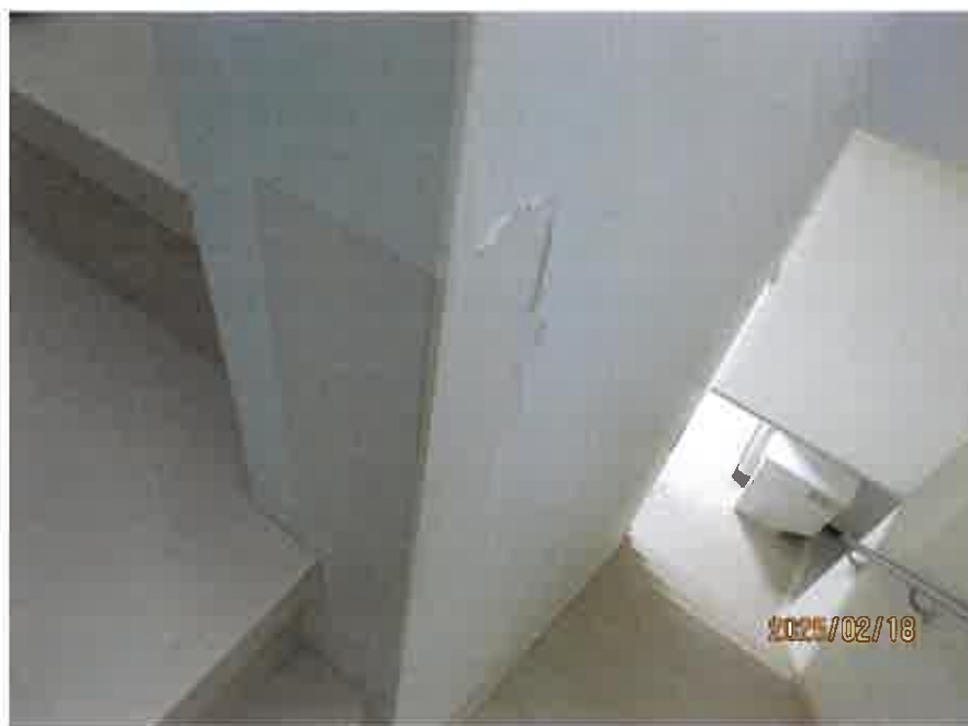
内壁クロスの損傷
