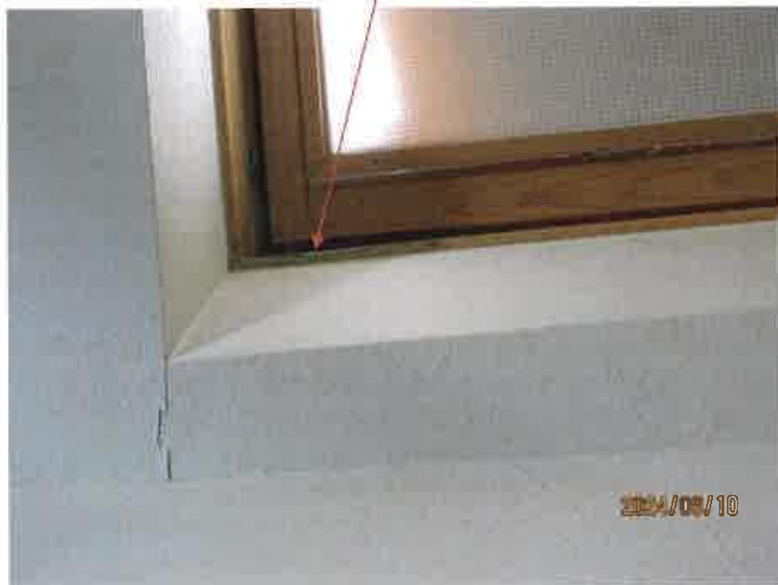
所有者が示した雨漏り跡
