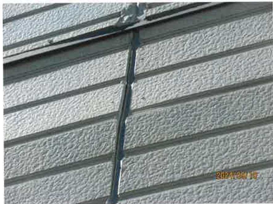
外壁が浮いている部分
