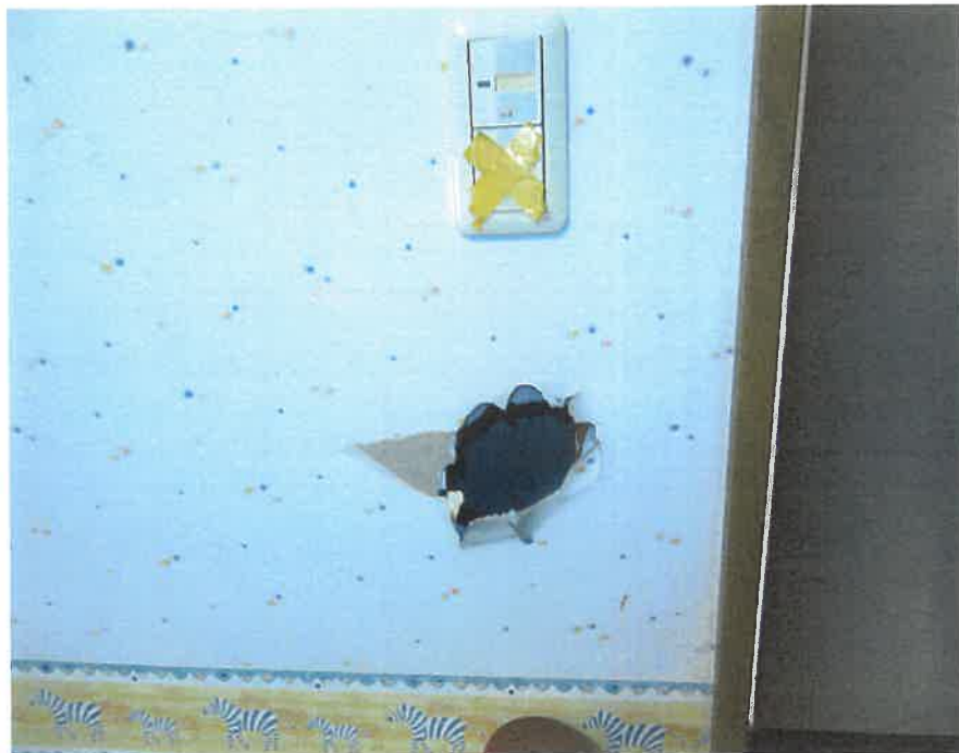
壁にある損傷(穴)
