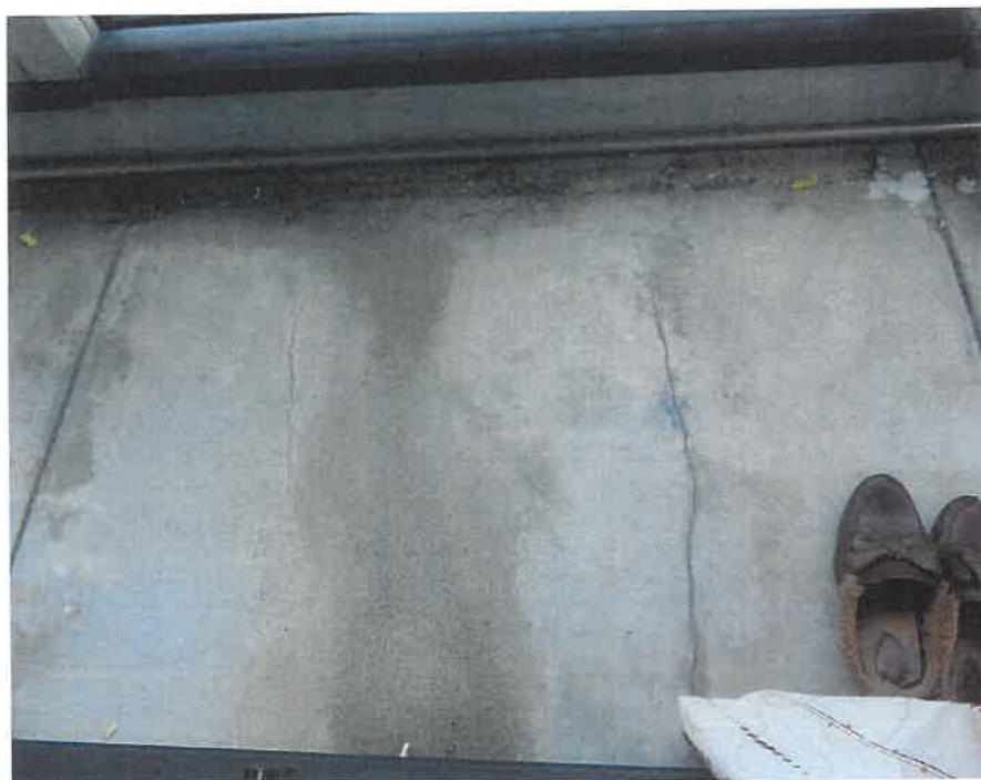
ベランダの床にある亀裂
