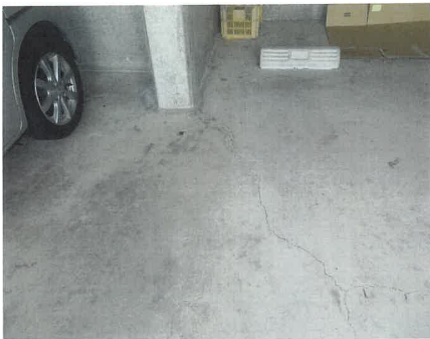
コンクリートの床面にある亀裂
