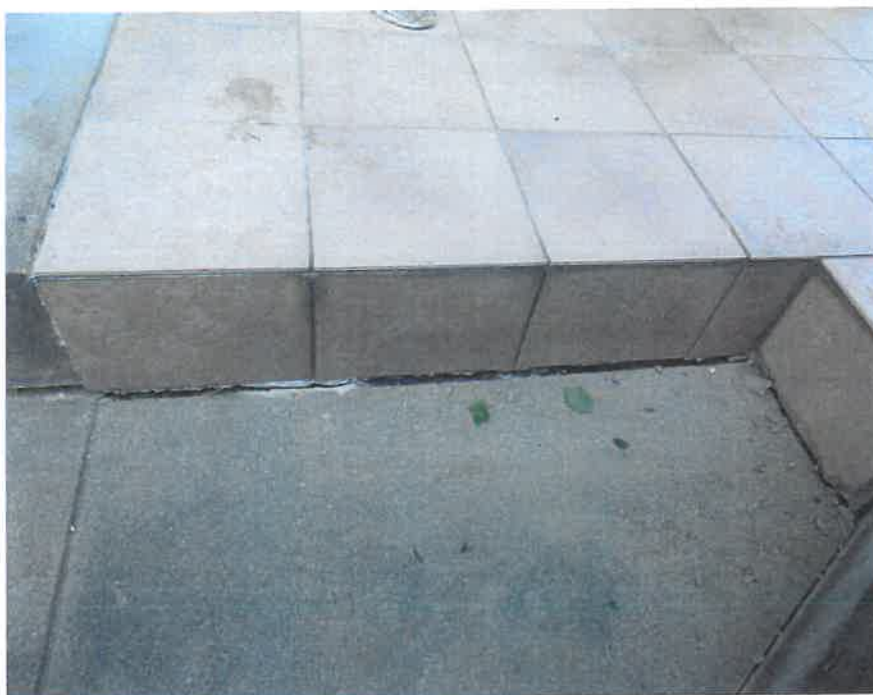
玄関ポーチの境目に生じた隙間
