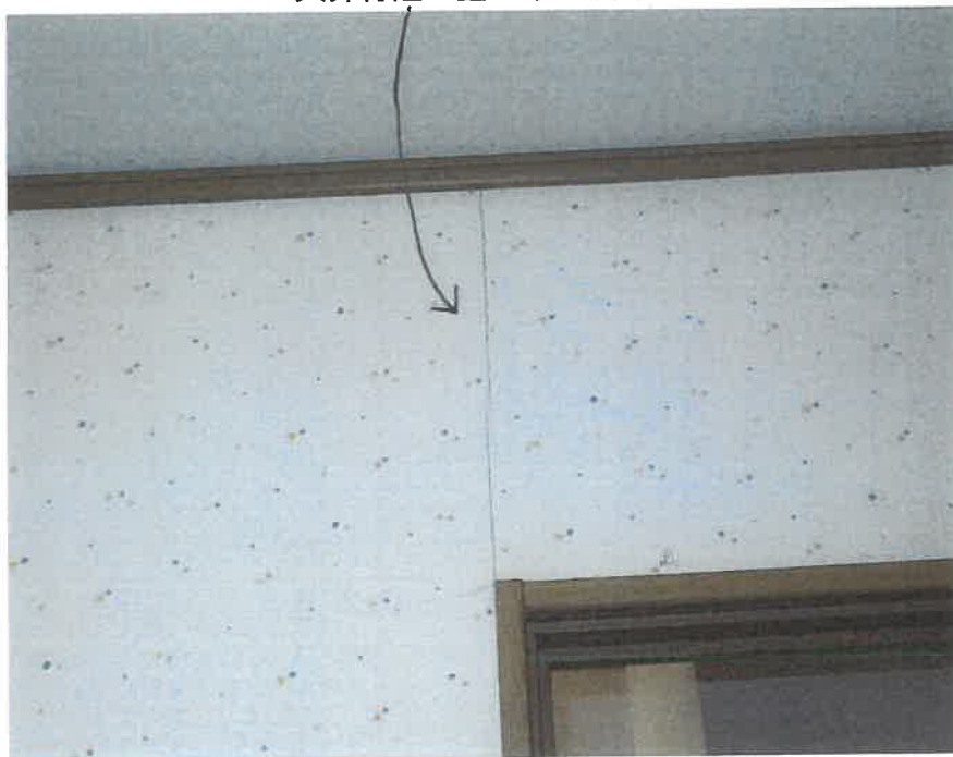
天井付近の壁にある亀裂
