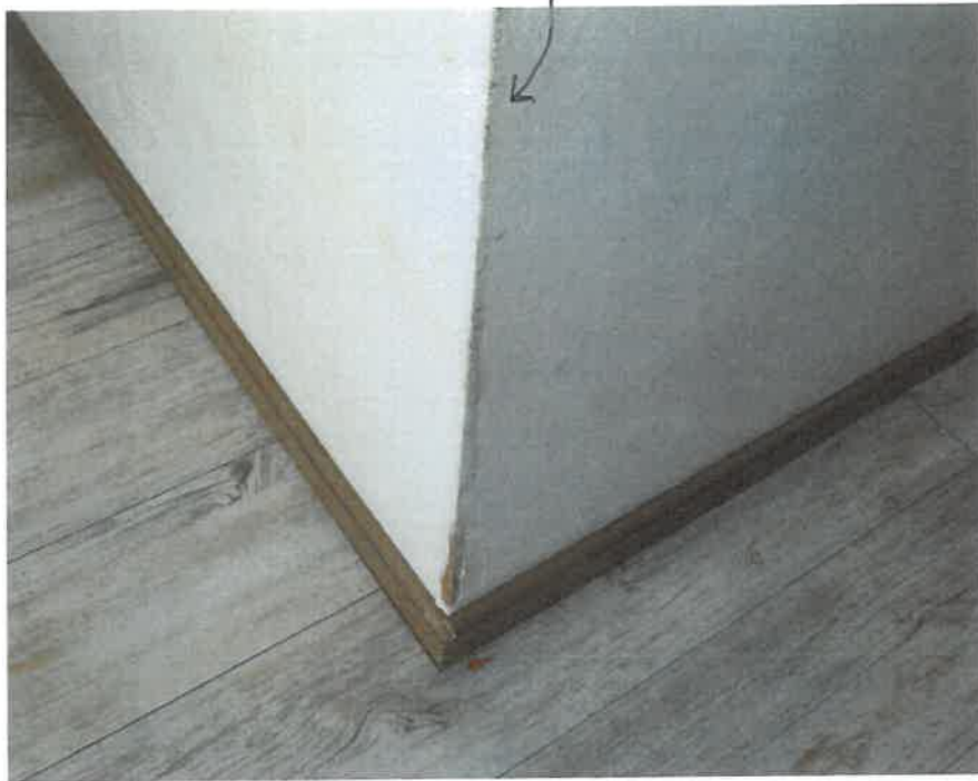
壁の角付近にある損傷
