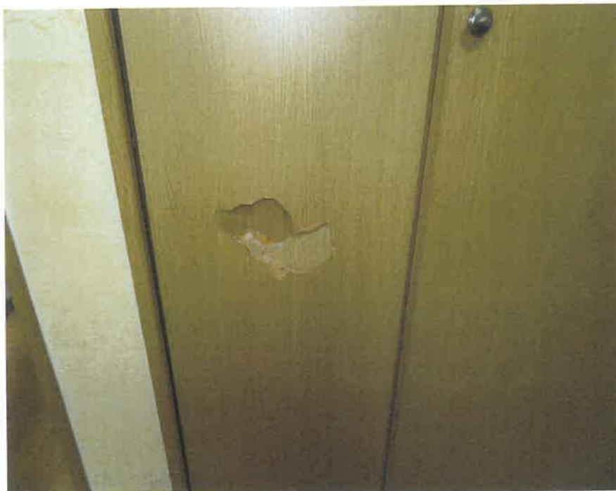
クローゼット扉の損傷
