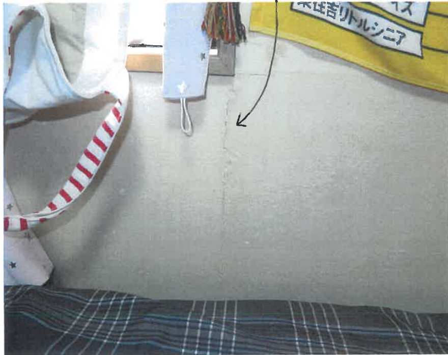
壁にある亀裂
