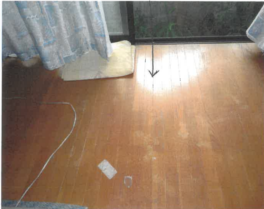
フローリングの摩耗
