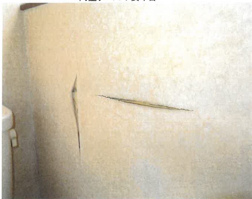
内壁クロスの裂け目
