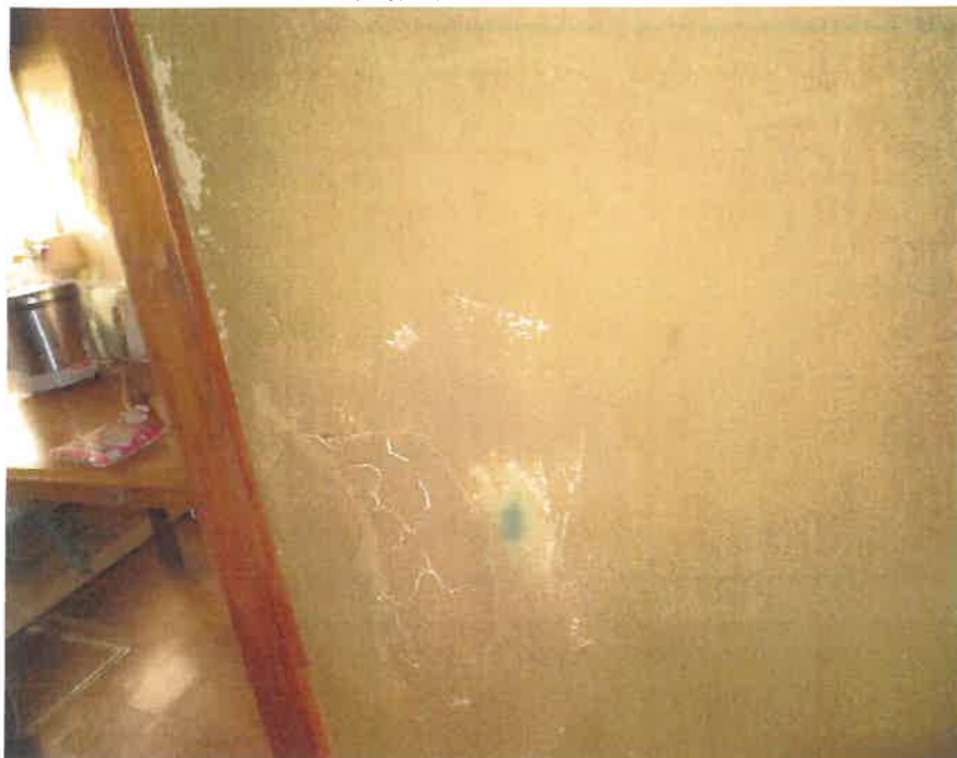
壁の損傷・劣化
