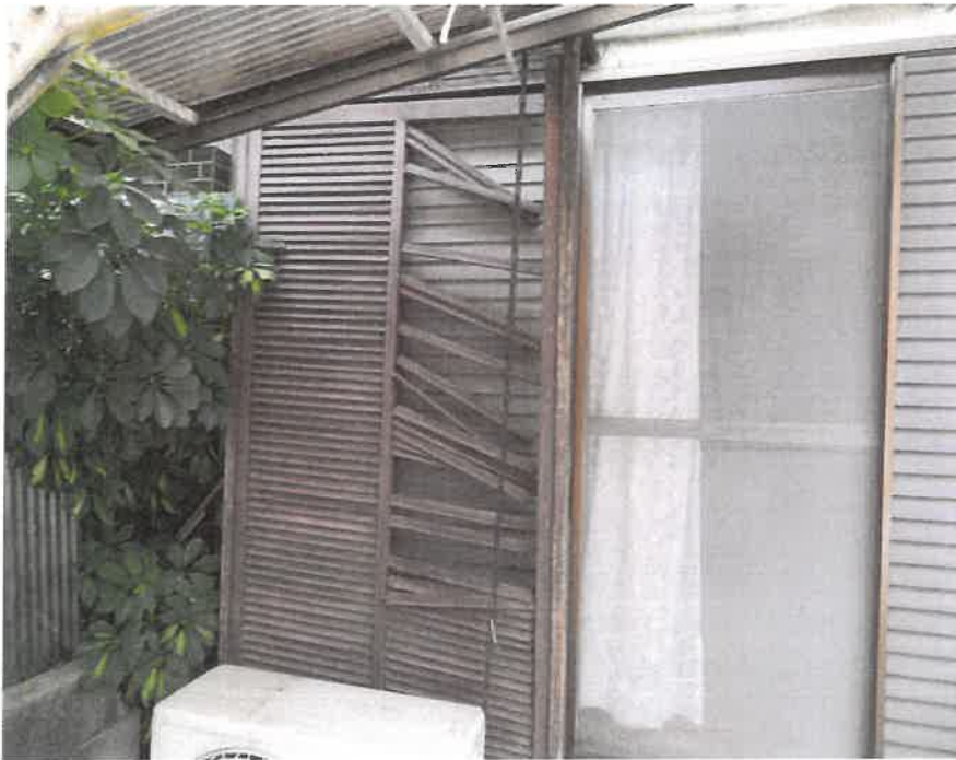
木製雨戸の損傷
