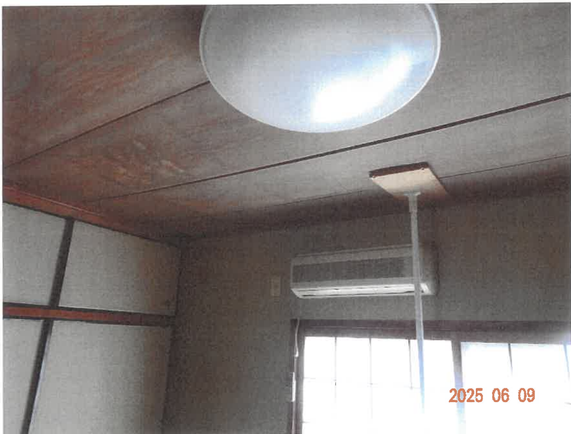
⑭ 3階天井の雨漏りあとと推測されるしみ
