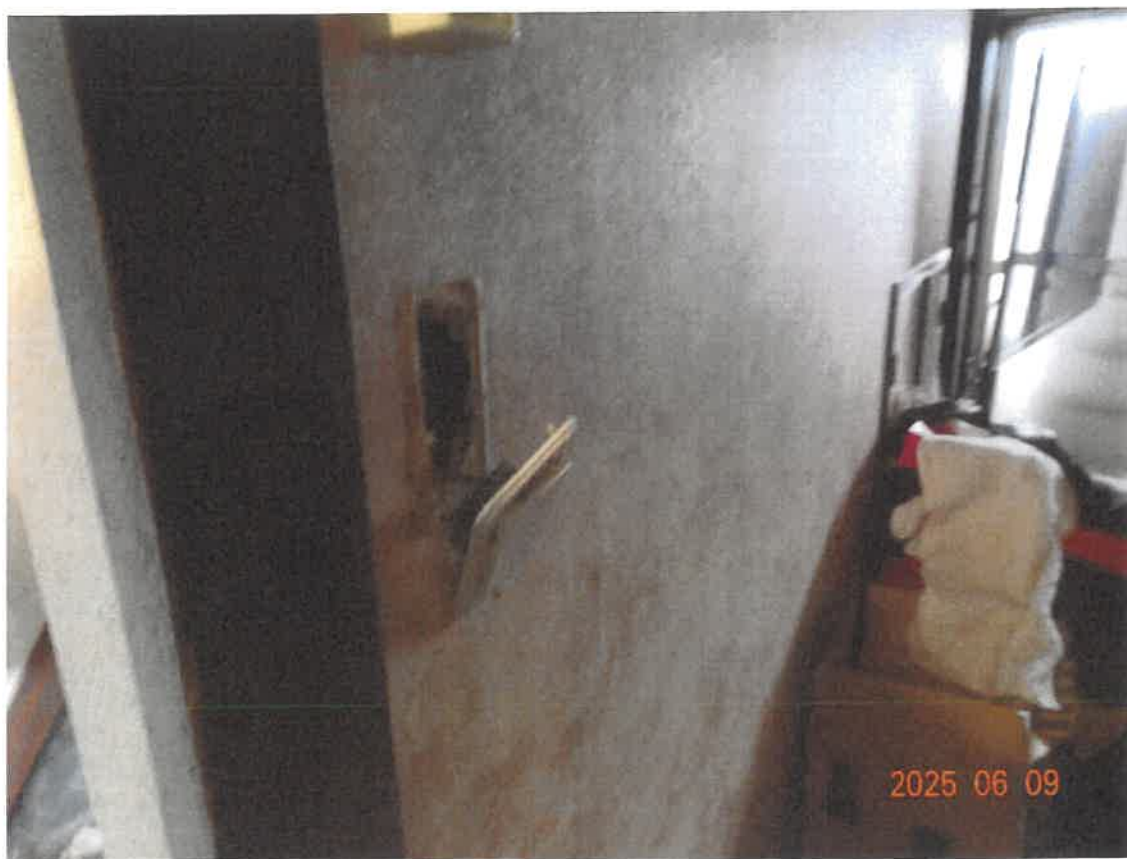
⑦ 2階スイッチの剥落
