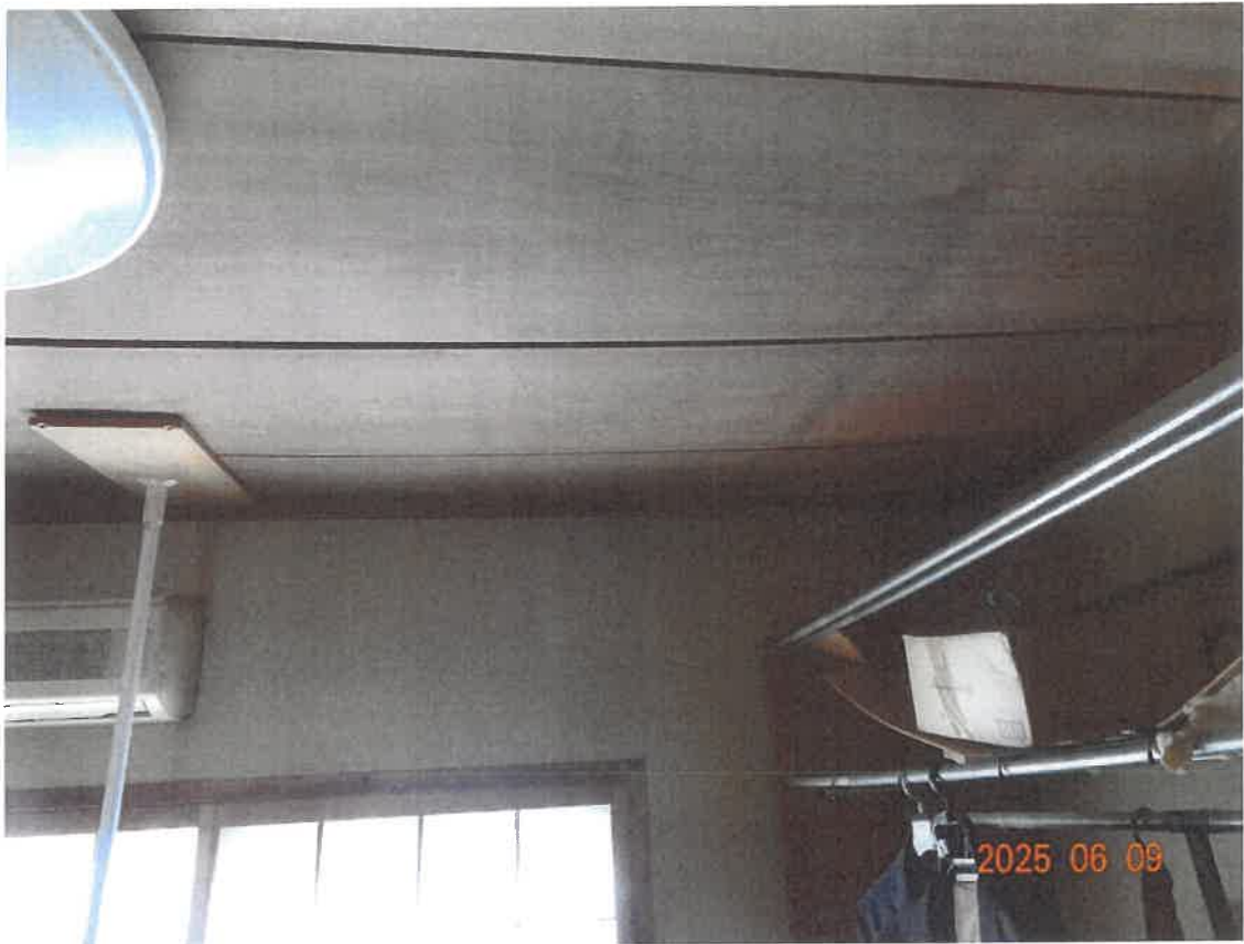
⑬ 3階天井の雨漏りあとと推測されるしみ
