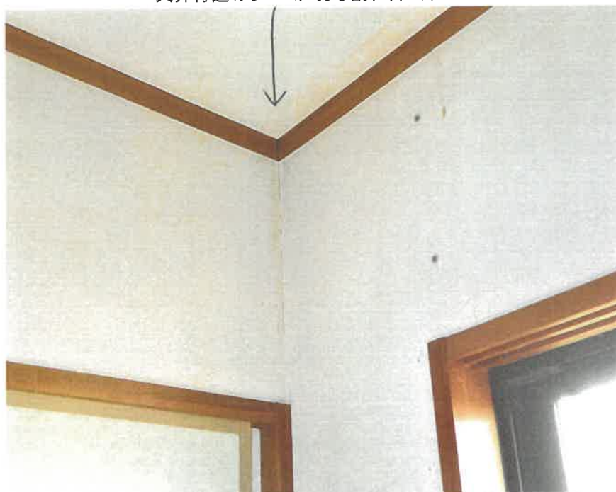
天井付近のクロスにある割れ目と汚れ
