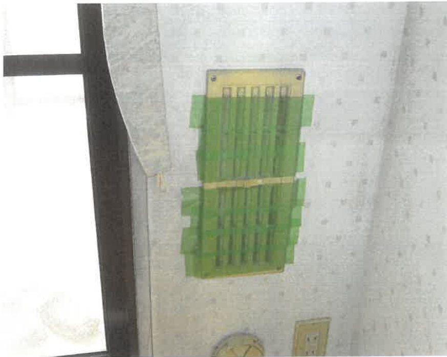
テープで塞がれた換気口
