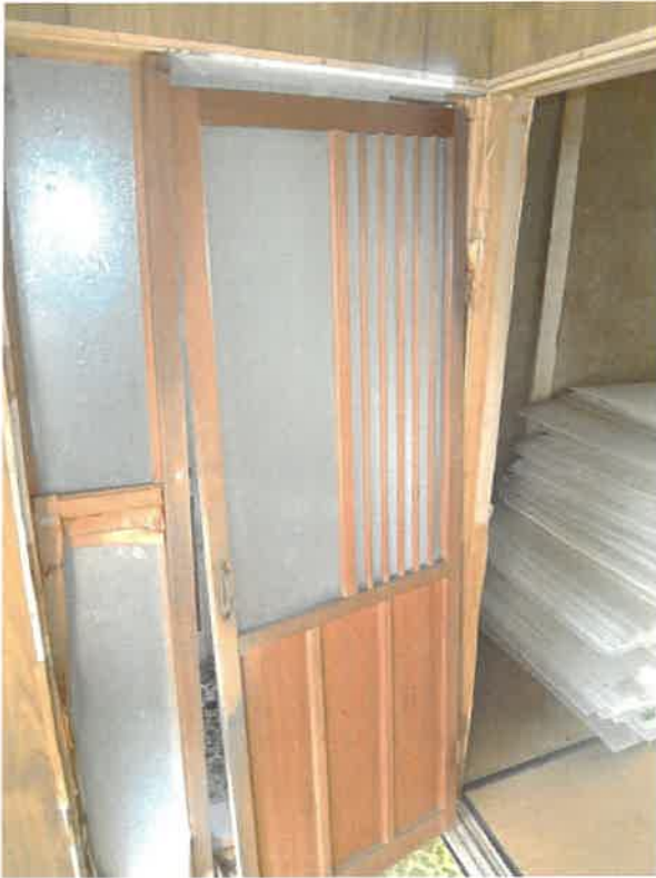
29 扉が外れている
