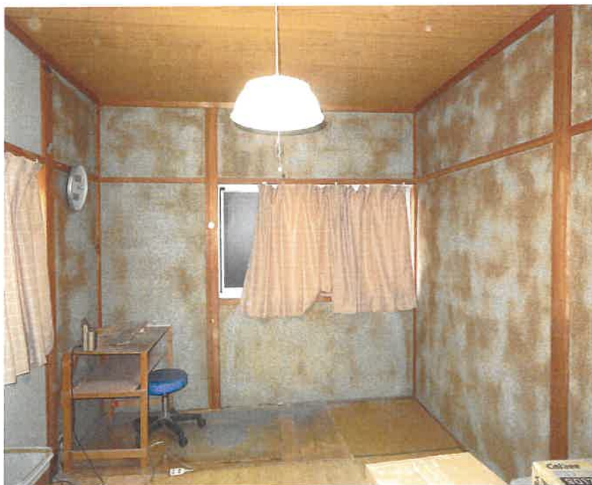
ほぼ全体的に生じている壁の汚損
