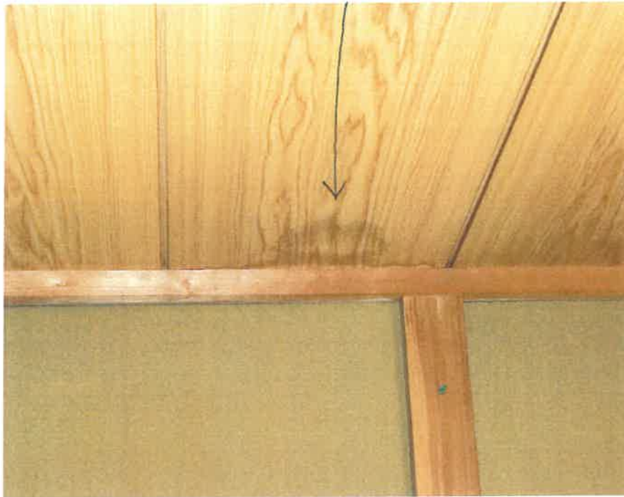
天井にある雨漏り跡のようなシミ
