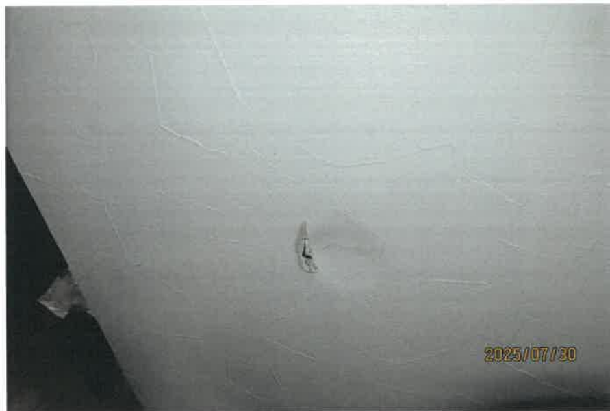
壁に穴が空いている状況
