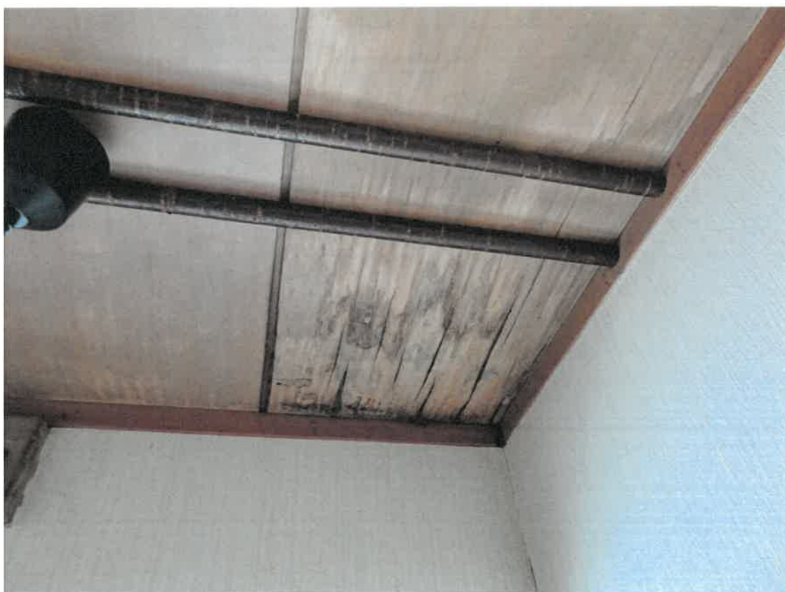
5 天井の損傷箇所
