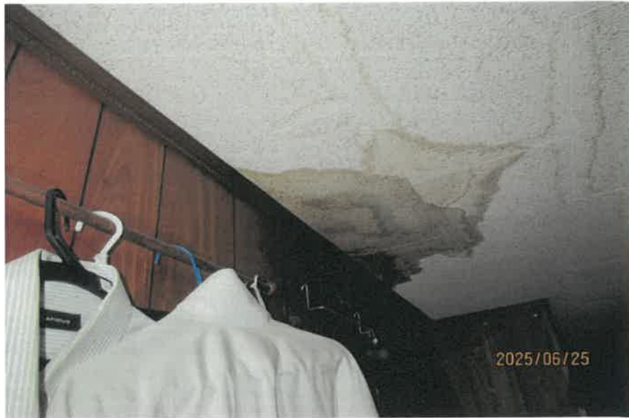
雨漏り跡の状況
