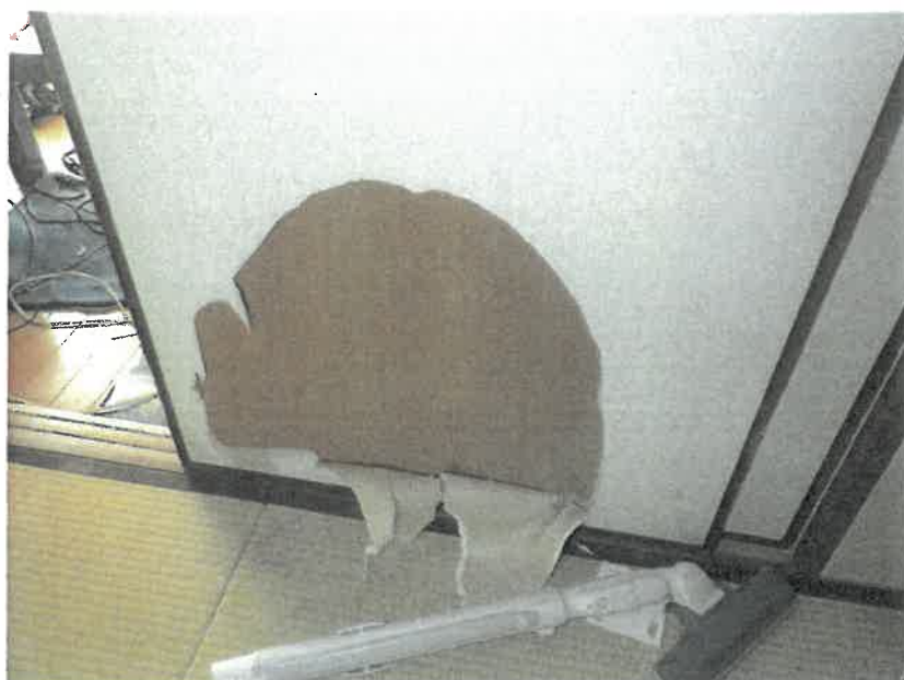
③ 襖の損傷状況
