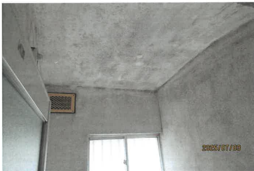
浴室の壁にカビが発生している状況
