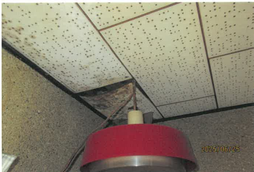
天井板が破損している状況
