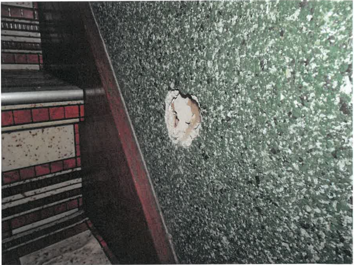
5 階段壁面の陥没
