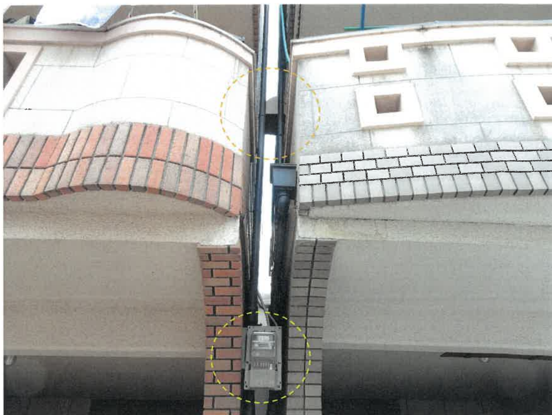
3 越境可能性あり（ダクト、電気メーター）
