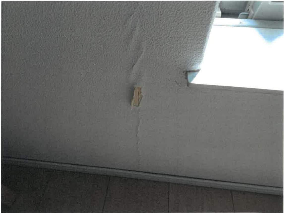
11 クロスの剥がれ
