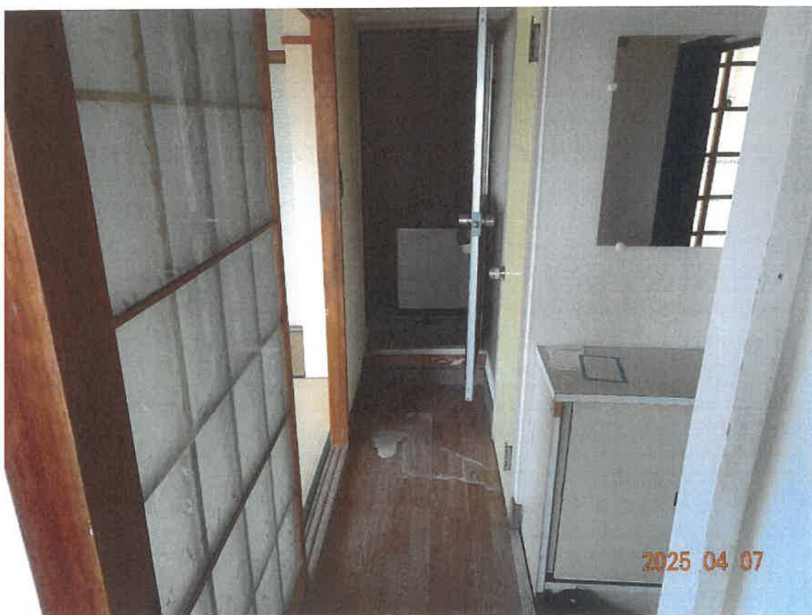
② 廊下の床のしみ
