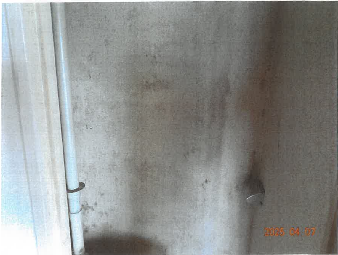
③トイレの壁の黒ずみ
