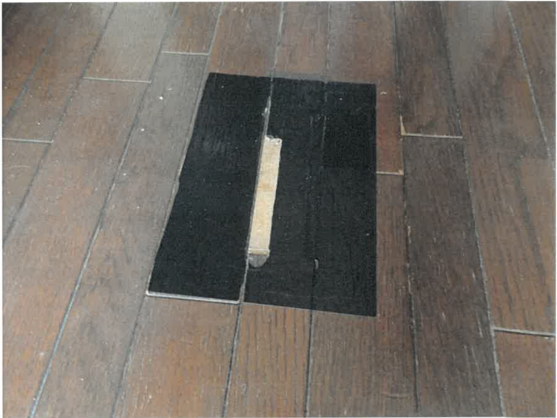
9 床の損傷部分
