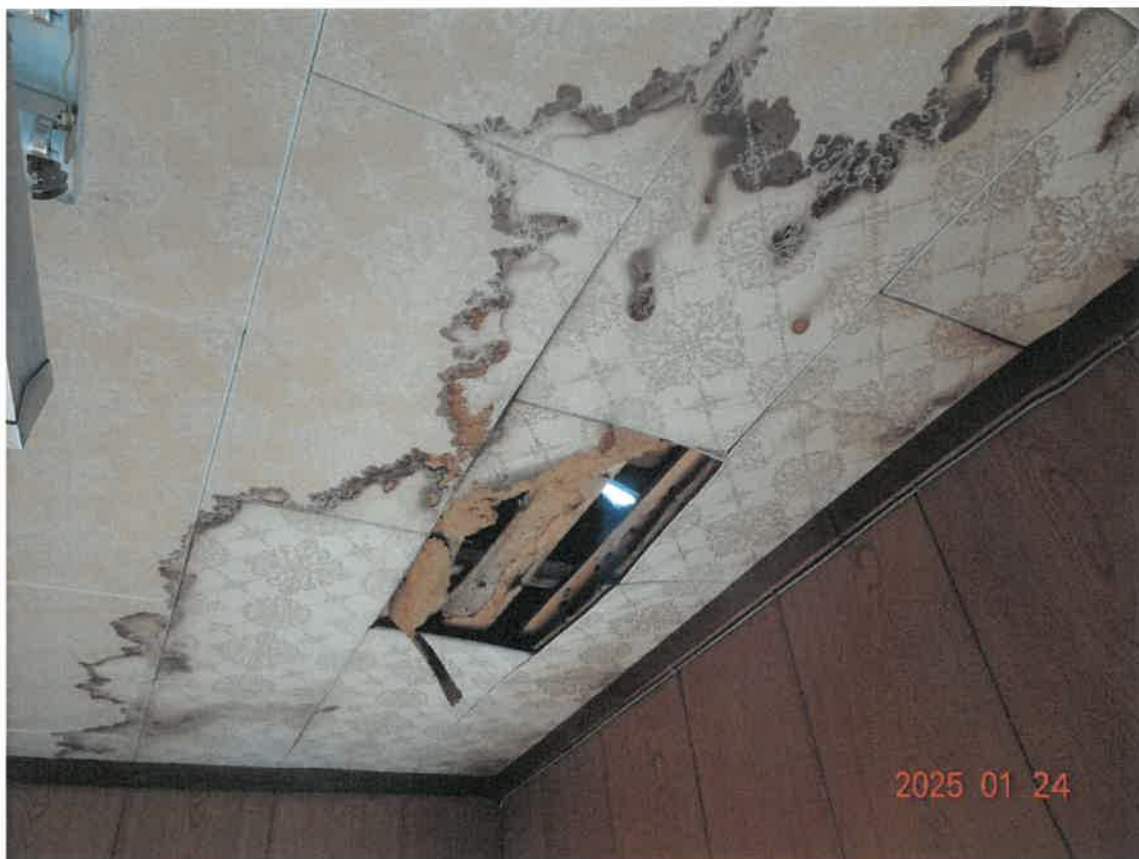
9 天井の損傷（雨漏り跡）
