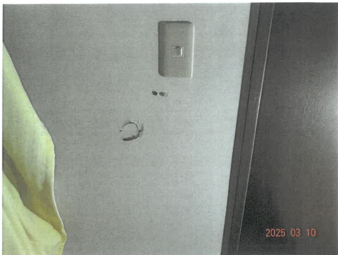
⑬ 3階北側洋室の壁の損傷
