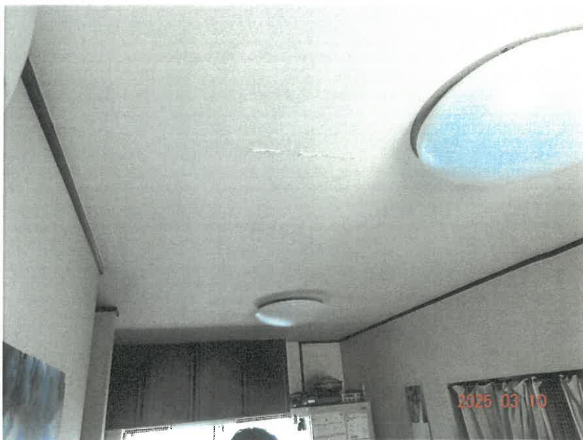
⑦リビング天井のひび割れ
