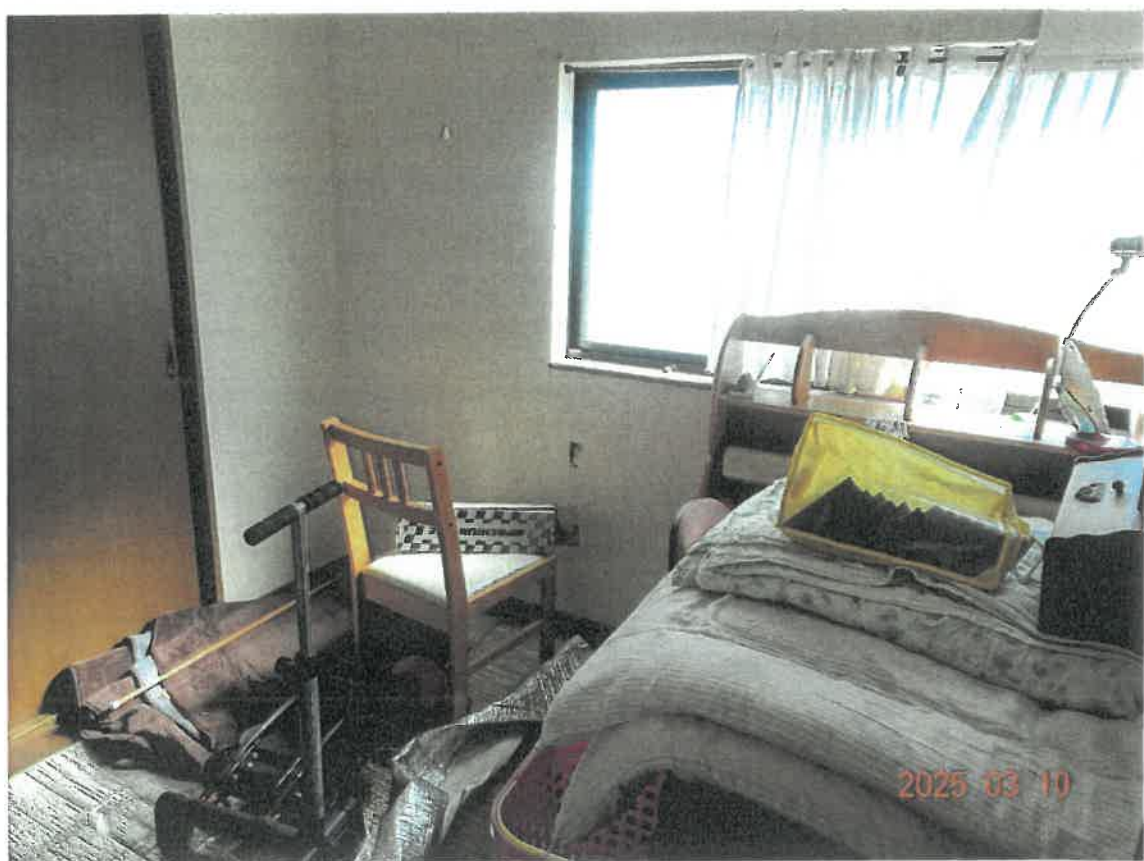
⑩ 3 階南側洋室の壁の損傷
