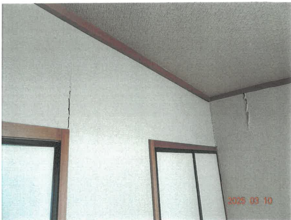
⑨ 3 階和室の壁のひび割れ
