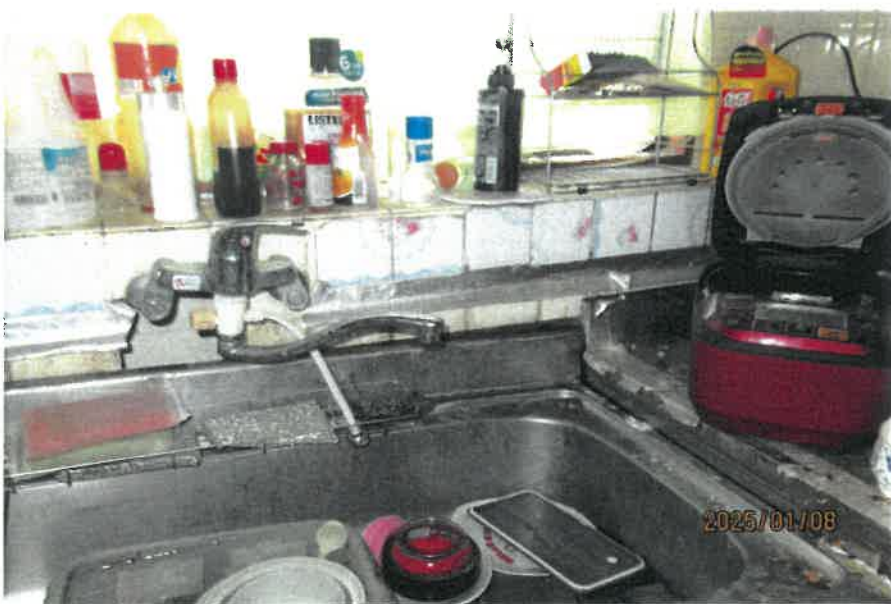
流し台が沈んでいる状況
