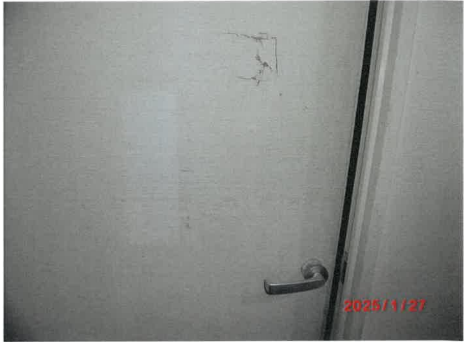
建具損傷部分
