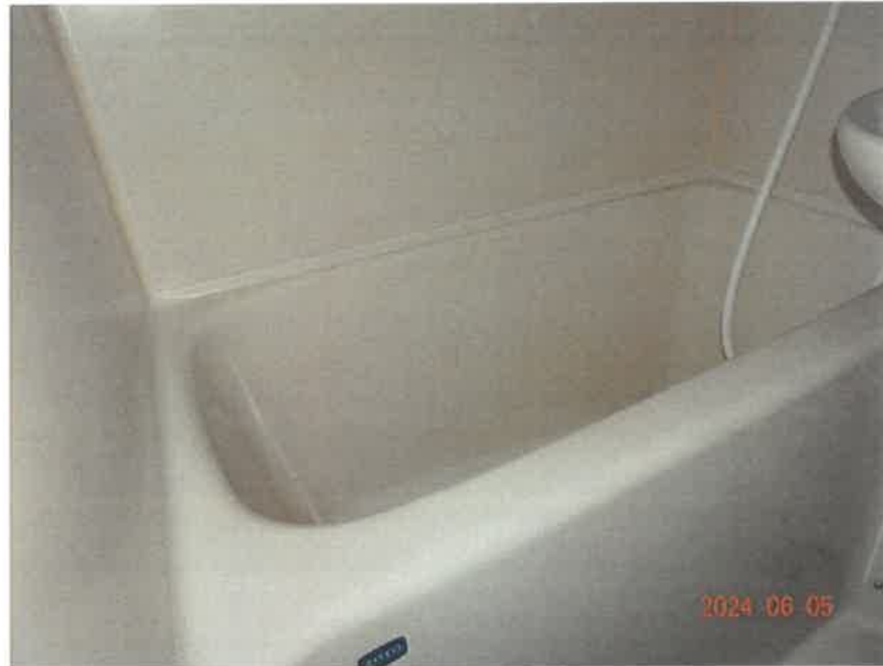
【111号室】(雨漏り箇所) 29
