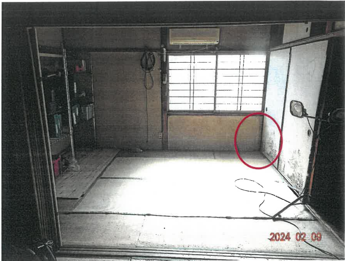
⑨ 2階南側和室の壁の損傷箇所
