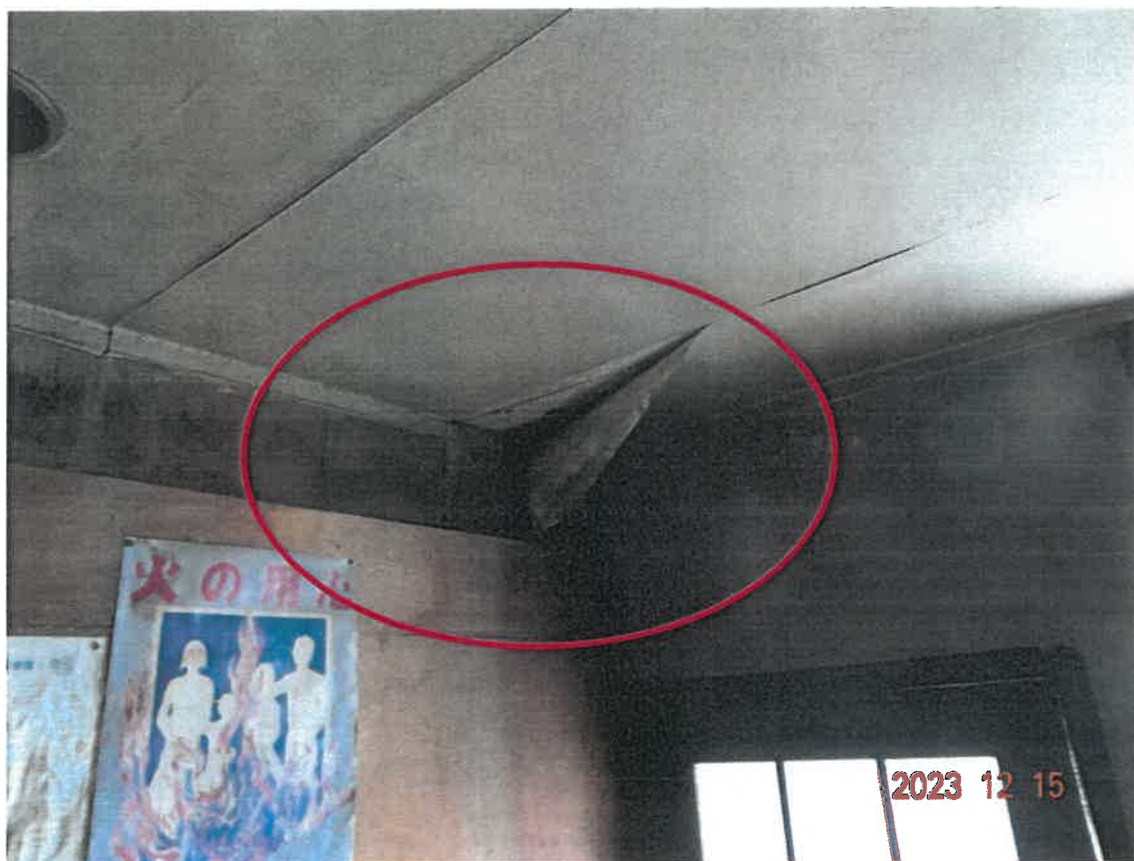
⑥5 増築部分（物件7の二階）の雨漏りのあとと思われる部分
