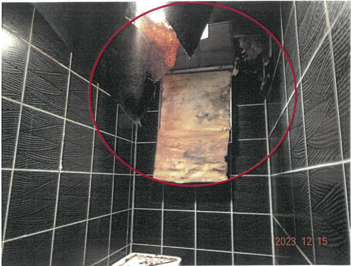
⑤③ 雨漏りによると思われる天井の損傷
