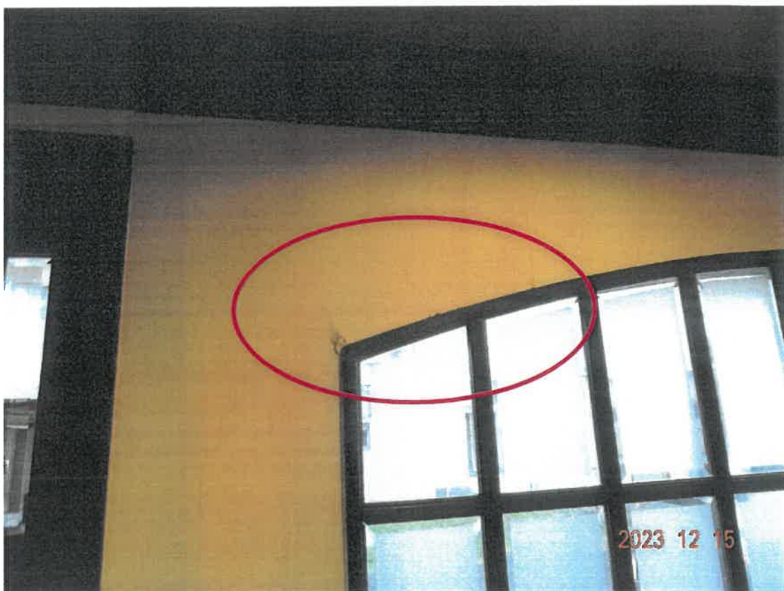
⑱壁の亀裂
