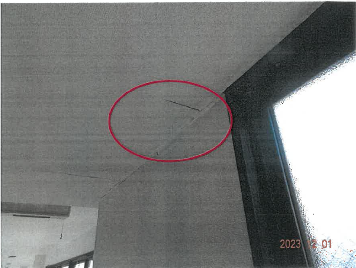
④⑧ ひび割れ
