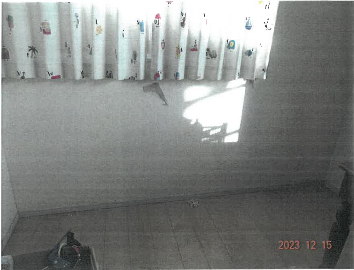
⑬ 壁紙の損傷箇所
