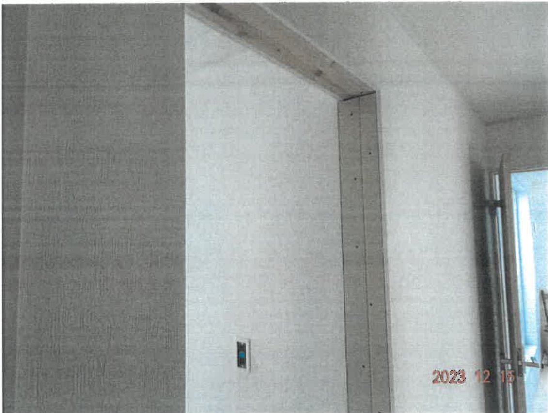
⑭ 扉及びその枠が欠落している2階中央の洋室
