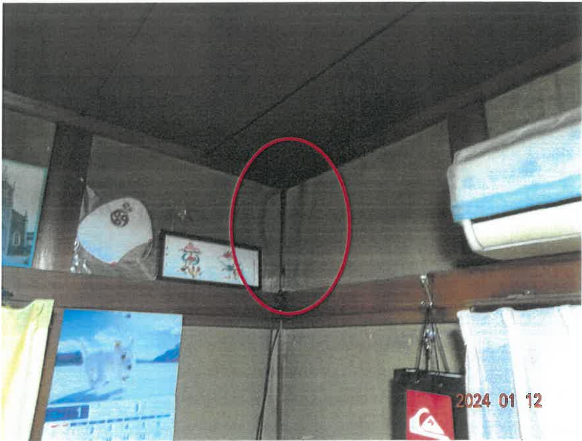
⑨ 2階和室の天井のしみ
