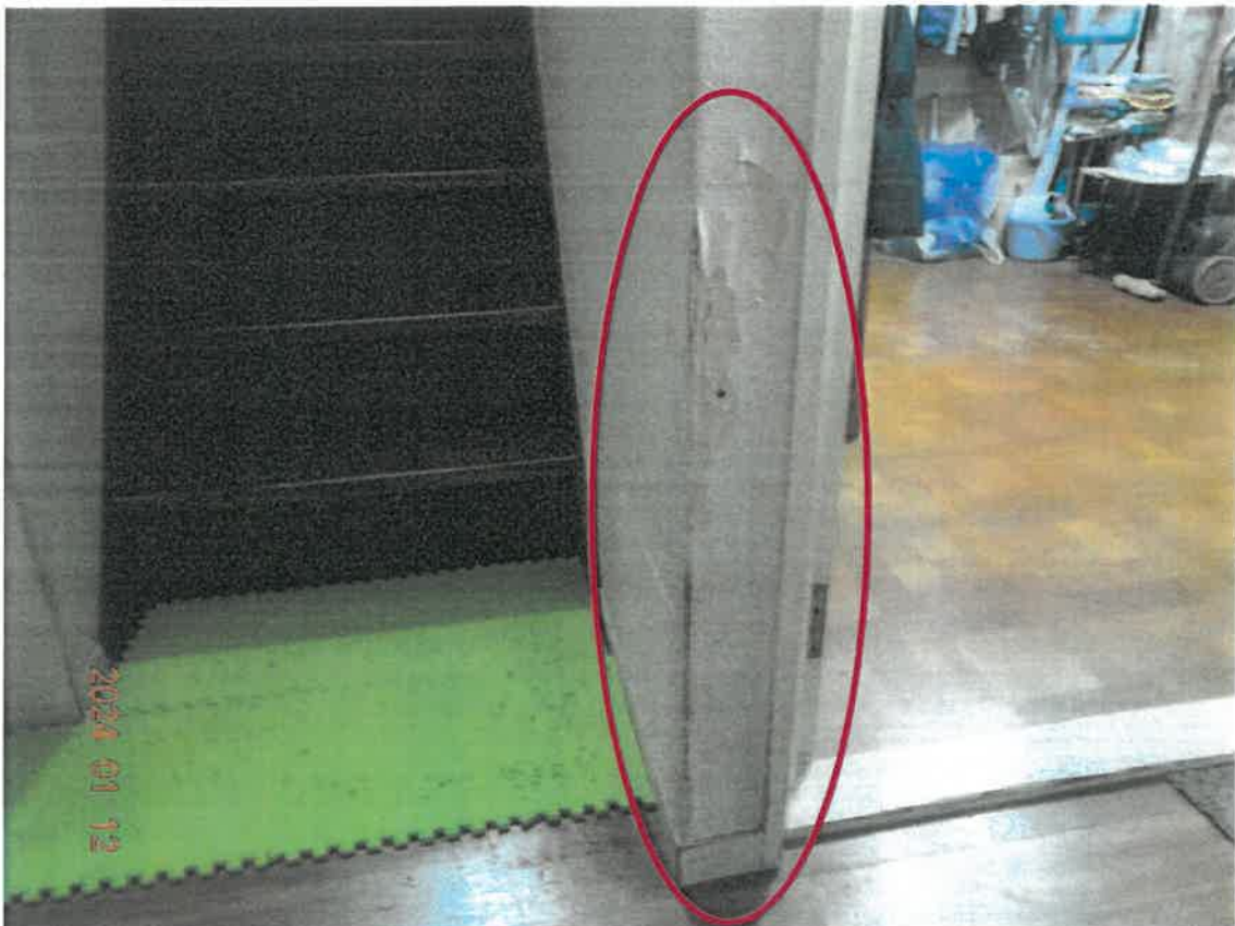
⑩ 2階廊下の壁の損傷箇所
