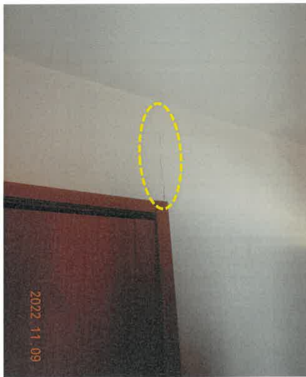
南西側洋室壁面のクラック
