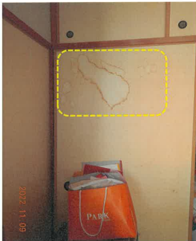
和室の襖の汚損
