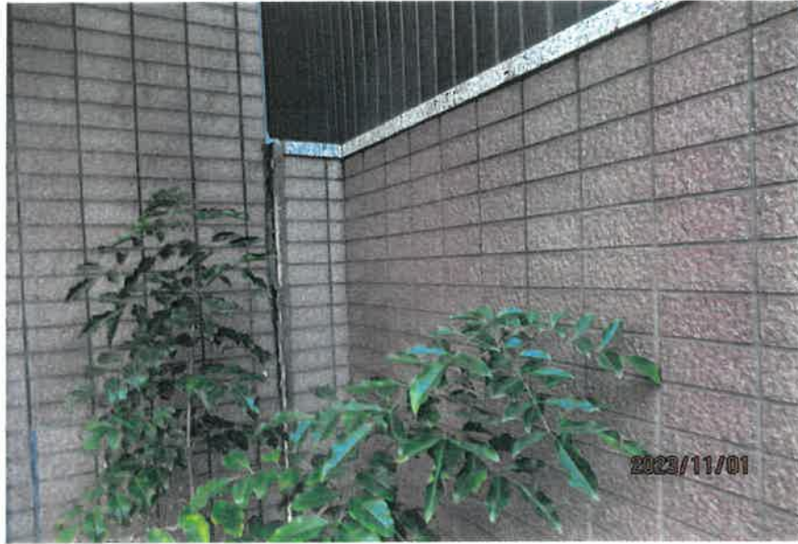
外壁にクラックが入っている状況
