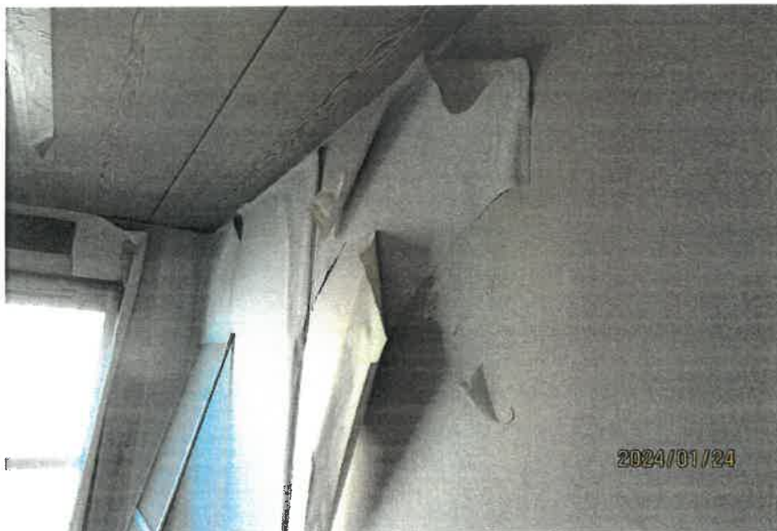
壁紙が剥離している状況
