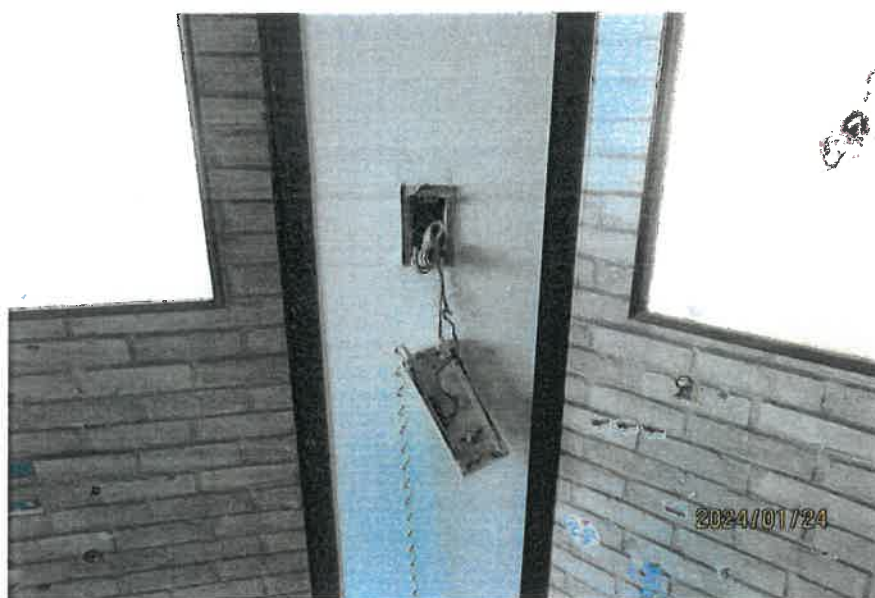
インターホンが壊れている状況
