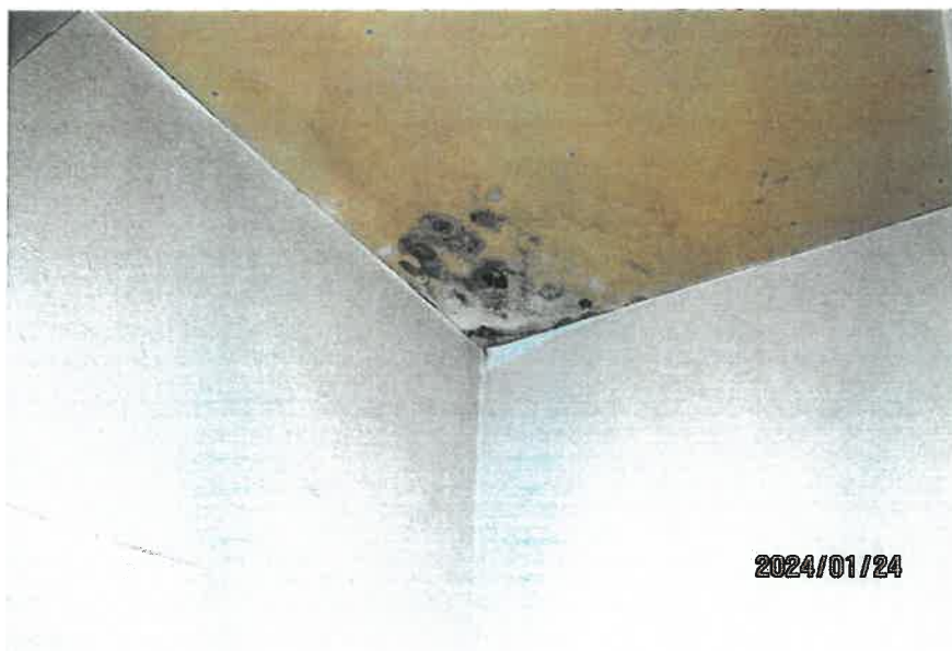
黒カビが発生している状況
