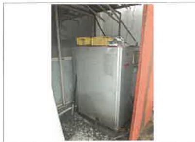
コンプレッサー
