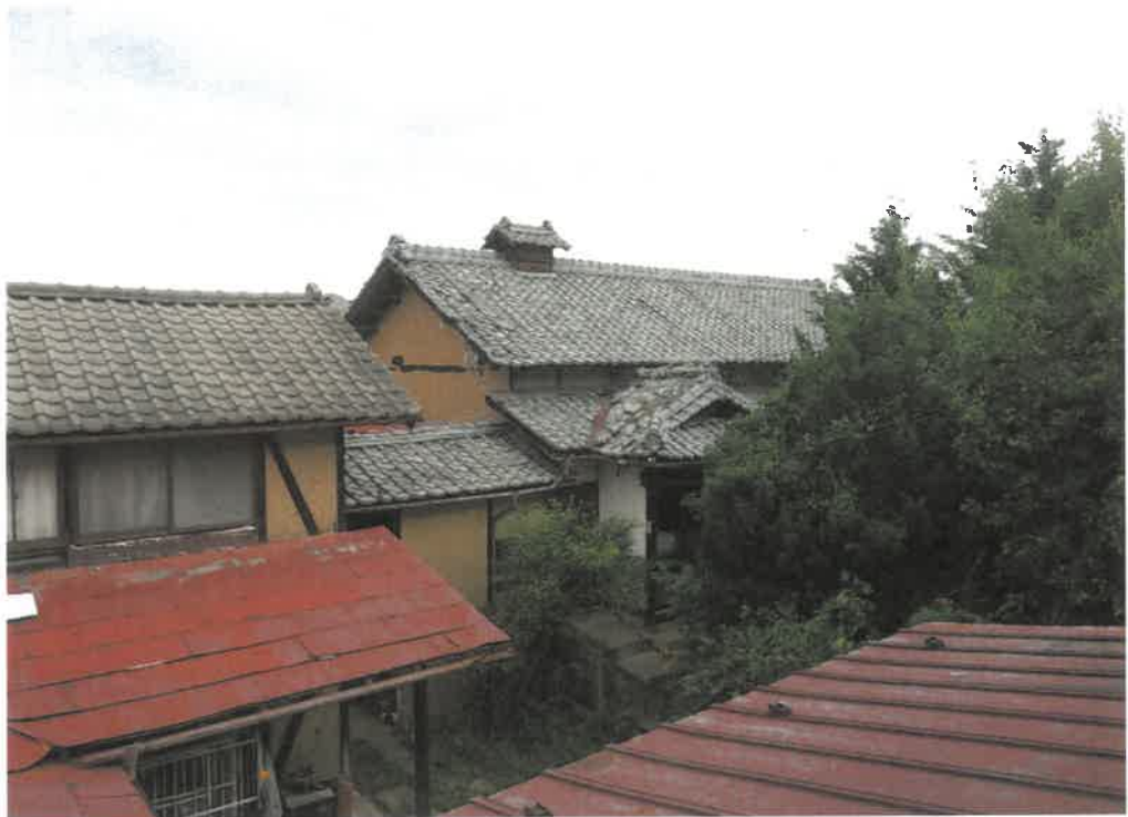
② 対象建物の屋根の破損状況
