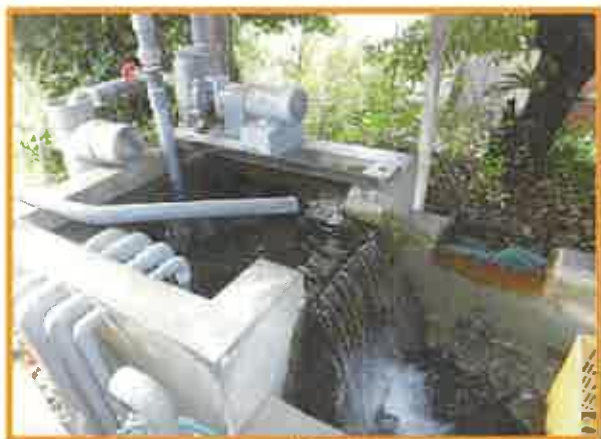
地下水汲み上げ井戸の状況
