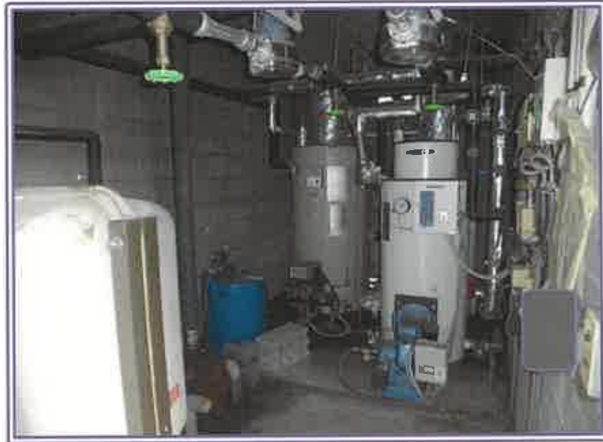
ボイラー室 / 物件8 未登記 附属建物 1
