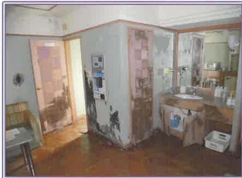
レストルーム / 物件7 既登記（符号1～3）附属建物（旅館（ラブホテルの個室）） ※ 中央のトイレからの水漏れと推察される カビ汚れが甚だしい
